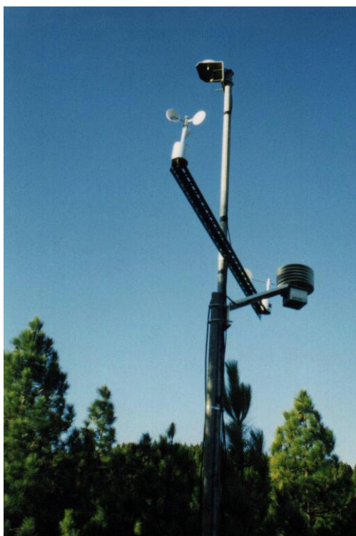
Foto 2.2. Estación meteorológica instalada en la torre del Morro de Isarda.
