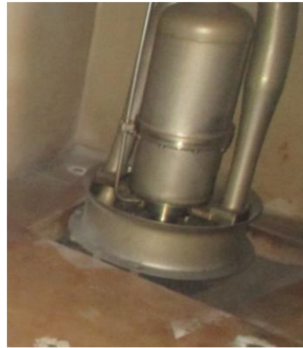
Ilustración 16; Bomba de descarga en el interior del tanque. Fuente; Trabajo de campo.
