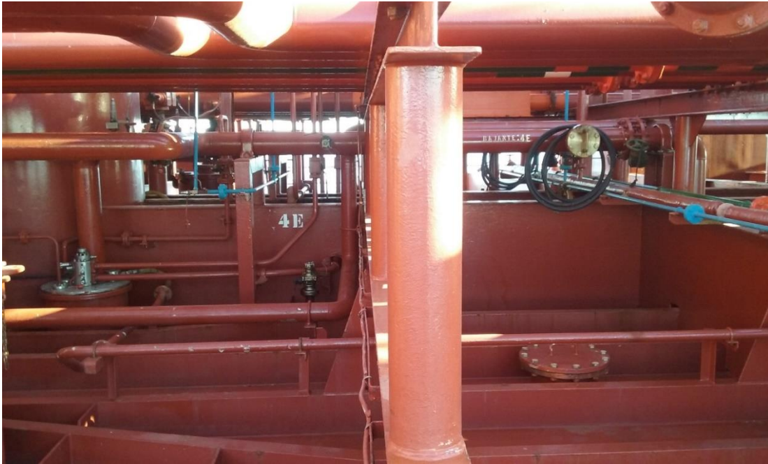
Ilustración 31; Bifurcación a la altura del tanque, salida y entrada. Fuente; Trabajo de campo.
