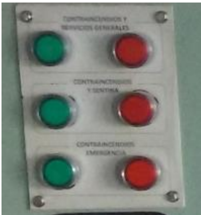
Ilustración 6; Arranque de las 3 bombas de emergencia dispuestas en el control de carga. Fuente; Trabajo de campo.
