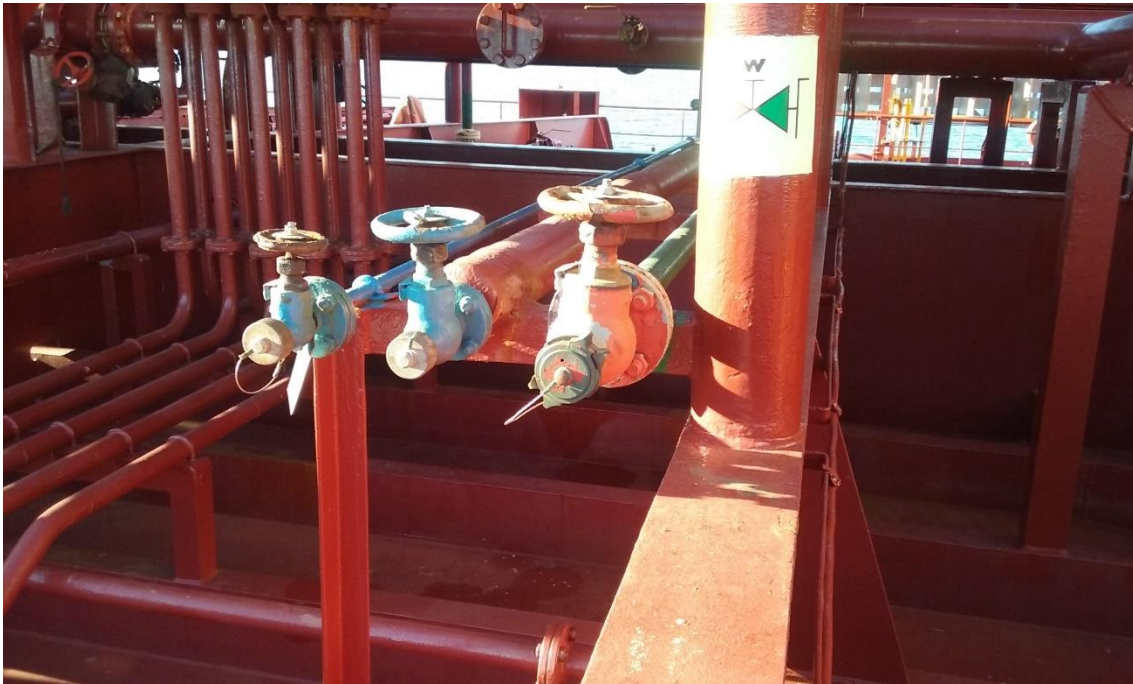
Ilustración 8; Hidrantes de cubierta. Fuente; Trabajo de campo.
