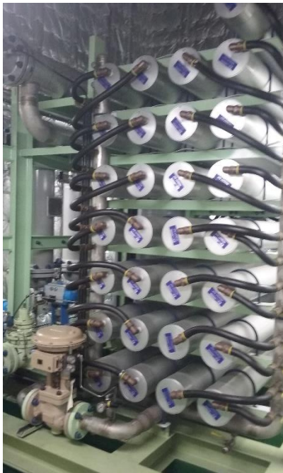
Ilustración 44; Membrans poliméricas del sistema del gas inerte. Fuente; Trabajo de campo.
