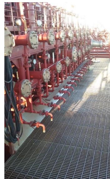
Ilustración 14; Enjaretado de la bandeja debajo de los manifolds. Fuente; Trabajo de campo.
