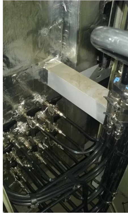
Ilustración 41; Válvulas de cada tanque de lastre conectados al GAS SAMPLING. Fuente; Trabajo de campo.
