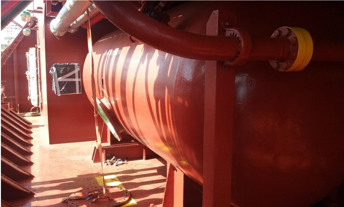
Ilustración 46; Botella de almacenaje Nitrógeno en cubierta. Fuente; Trabajo de campo.
