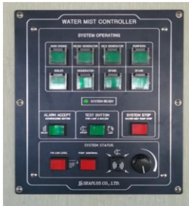
Ilustración 12; Panel de control de rociadores. Fuente; Trabajo de campo.
