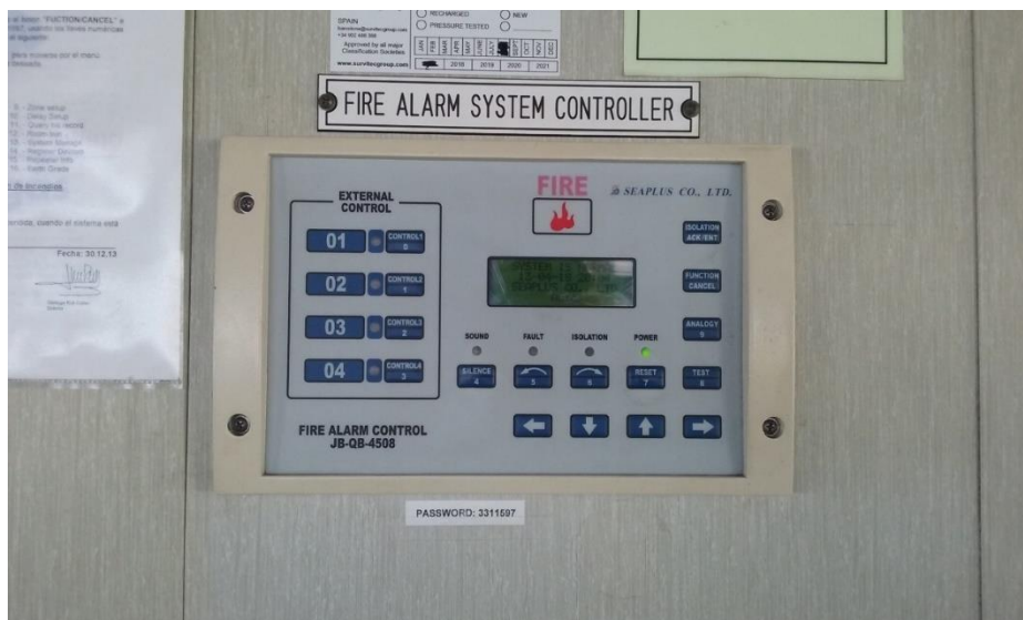
Ilustración 5; Panel de controlador de alarmas del sistema CI. Fuente; Trabajo de campo.
