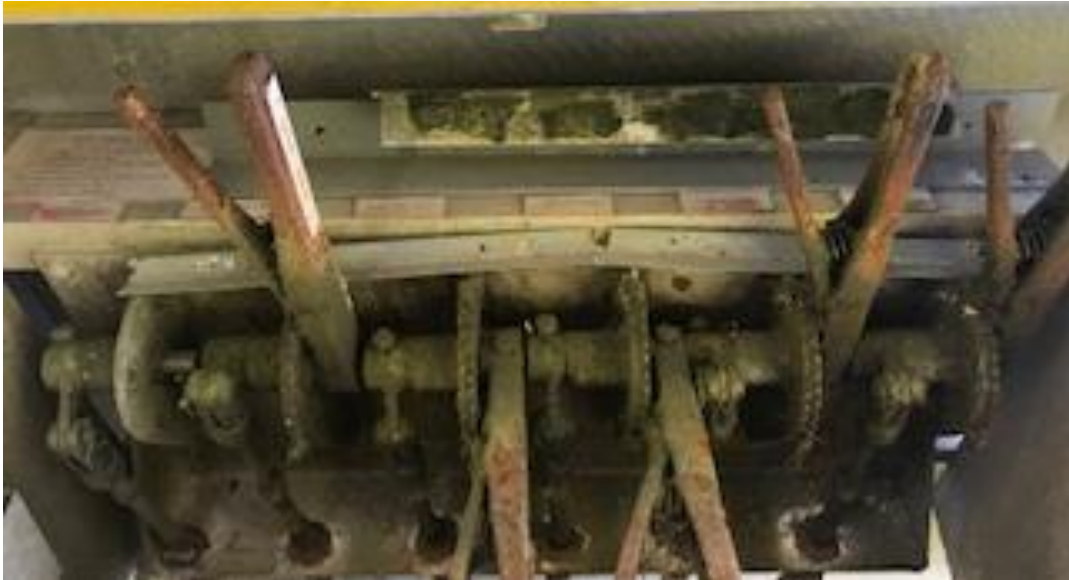
Imagen 13: Válvulas manuales de rociadores Fuente: Trabajo de campo
