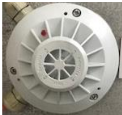
Imagen 25: Detector de calor Fuente: Trabajo de campo
