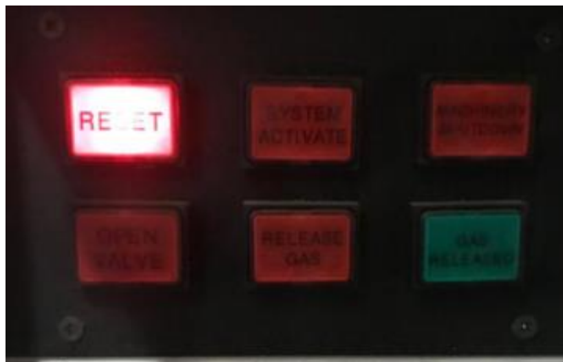
Imagen 19: Panel de disparo de CO 2 de sala de máquinas desde la antesala Fuente: Trabajo de campo
