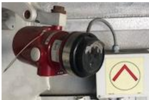
Imagen 23: Detector de llama Fuente: Trabajo de campo
