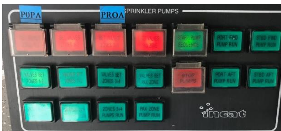
Imagen 12: Panel de control de rociadores desde el puente Fuente: Trabajo de campo
