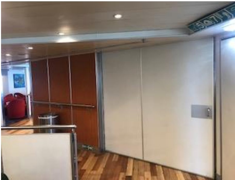
Imagen 6: Puerta corta humo Fuente: Trabajo de campo
