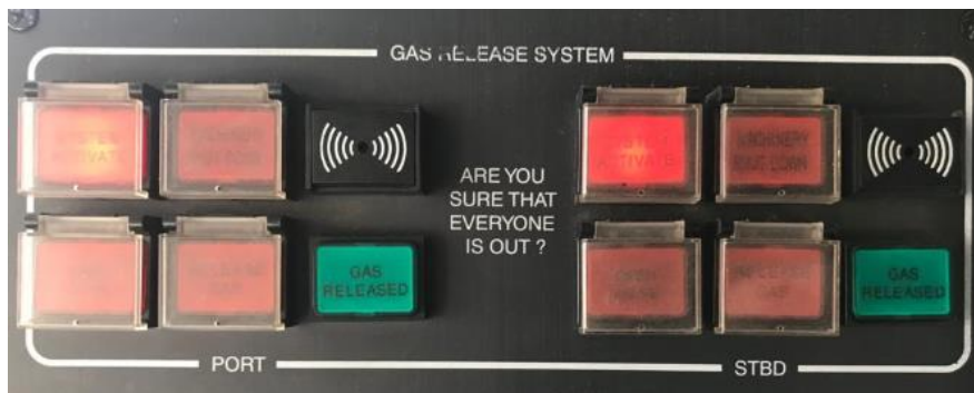
Imagen 18: Panel de disparo de CO 2 de sala de máquinas desde el puente Fuente: Trabajo de campo
