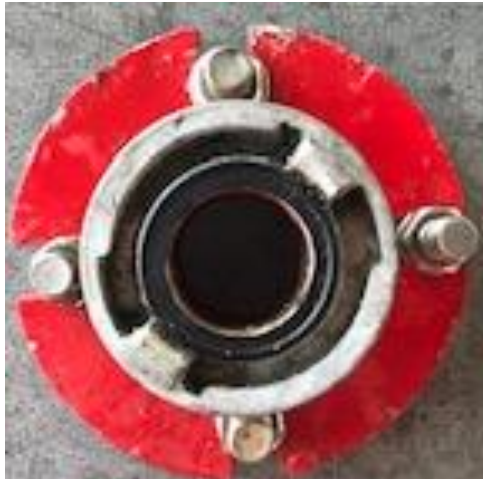
Imagen 26: Toma internacional a tierra Fuente: Trabajo de campo
