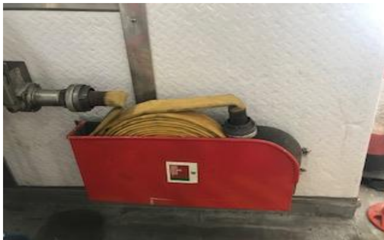
Imagen 29: Hidrante y manguera contra incendios Fuente: Trabajo de campo
