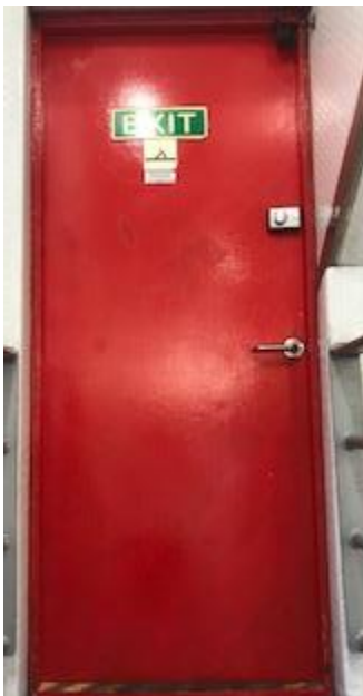
Imagen 30: Puerta contra incendios Fuente: Trabajo de campo
