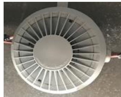
Imagen 24: Detector de humo Fuente: Trabajo decampo
