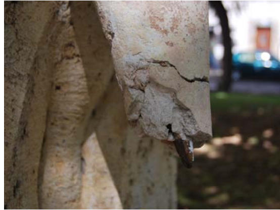
Imagen 8. - Detalle de la varilla de hierro en forma de U.
