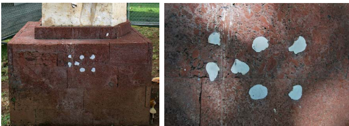
Imagen 11. Vista frontal de la base y detalle de los restos de adhesivo (pérdida de la placa).
