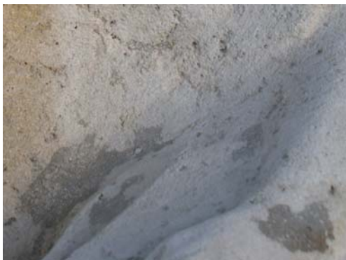
Imagen 21. - Manchas oscuras sobre la superficie
