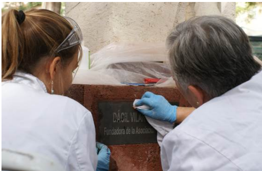
Imagen 44. Relleno de la junta y limpieza en húmedo para retirar restos de masillas de rejunte.
