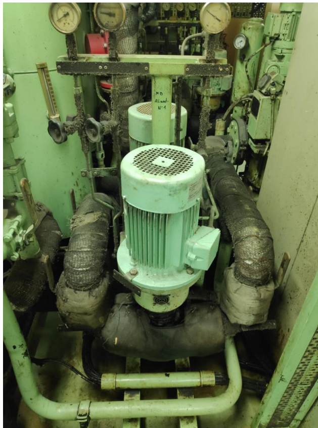
Ilustración 25: Bombas de alimentación del módulo
