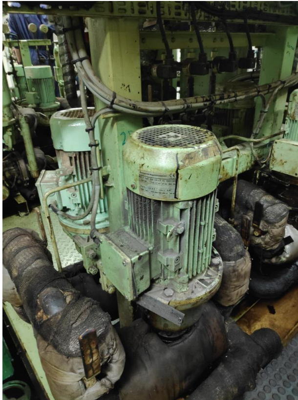
Ilustración 26: Bomba booster del módulo
