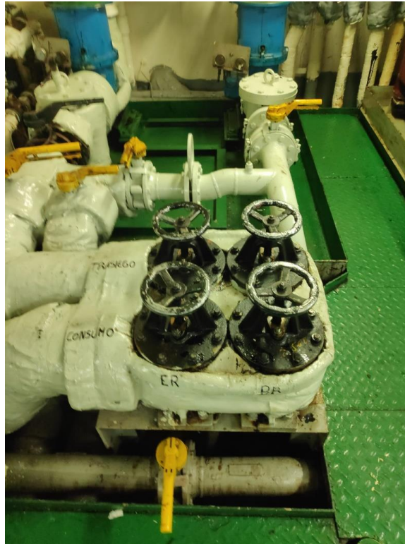
Ilustración 19: Bombas y línea de Trasiego
