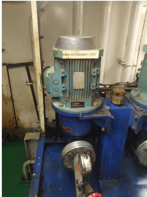
Ilustración 20: Bomba de alimentación de depuradora FO
