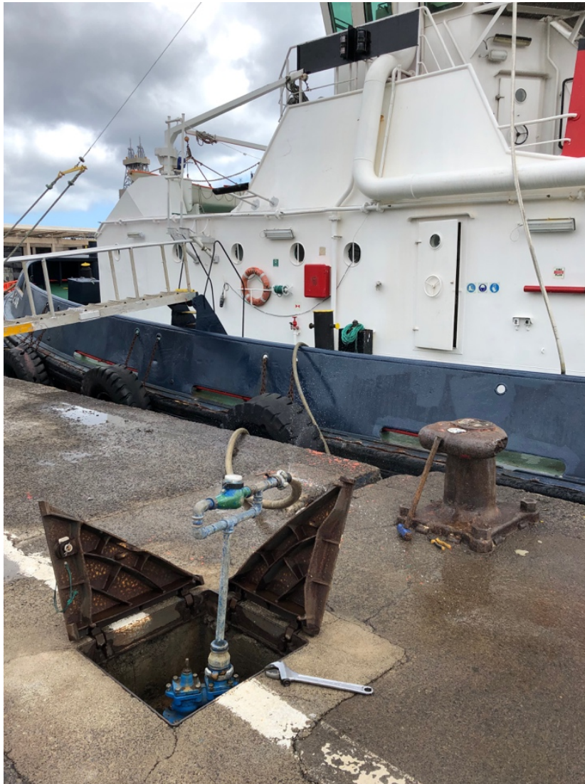
Ilustración 6. Abastecimiento de agua mediante la red de puerto
