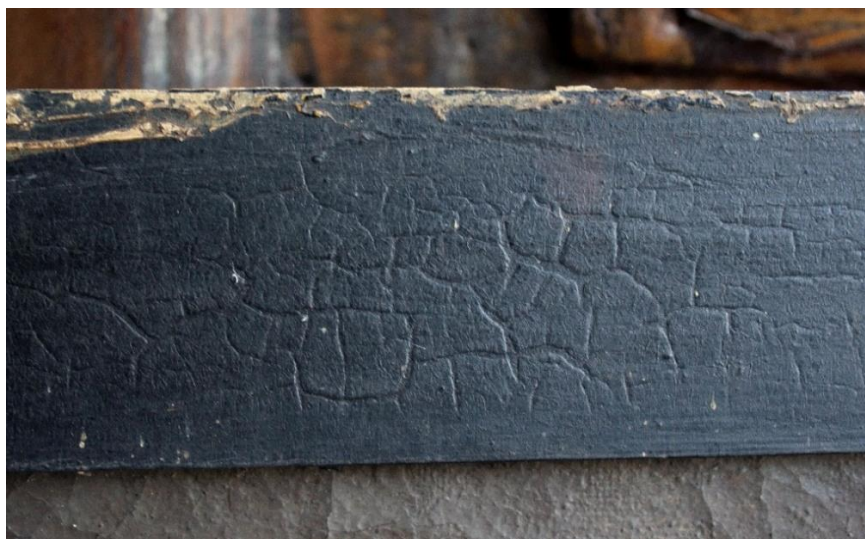
Fig. 91: Apreciación de las ya mencionadas grietas subyacente y la falta de policromía en el borde superior del marco
