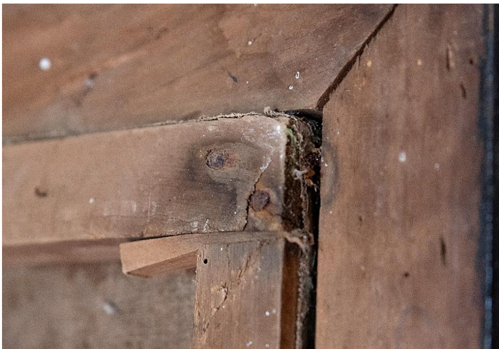
Fig. 74: Clavos oxidados localizados en la esquina superior derecha del bastidor
