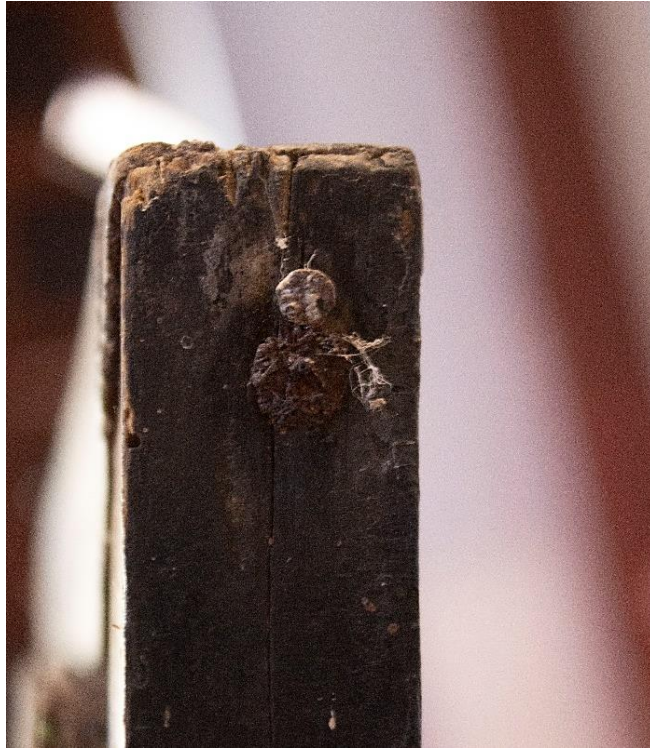
Fig. 90: Clavos oxidados y salientes en esquina superior derecha del marco, así como problemas estructurales del soporte
