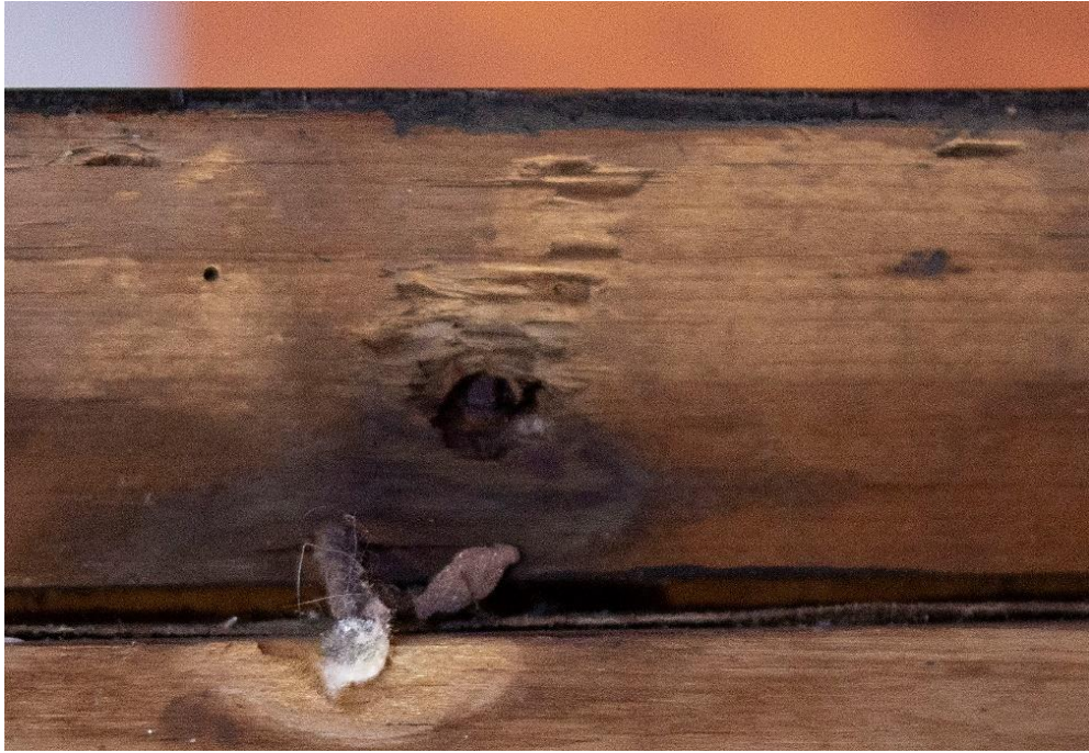
Fig. 88: Faltas de soporte en el reverso del marco
