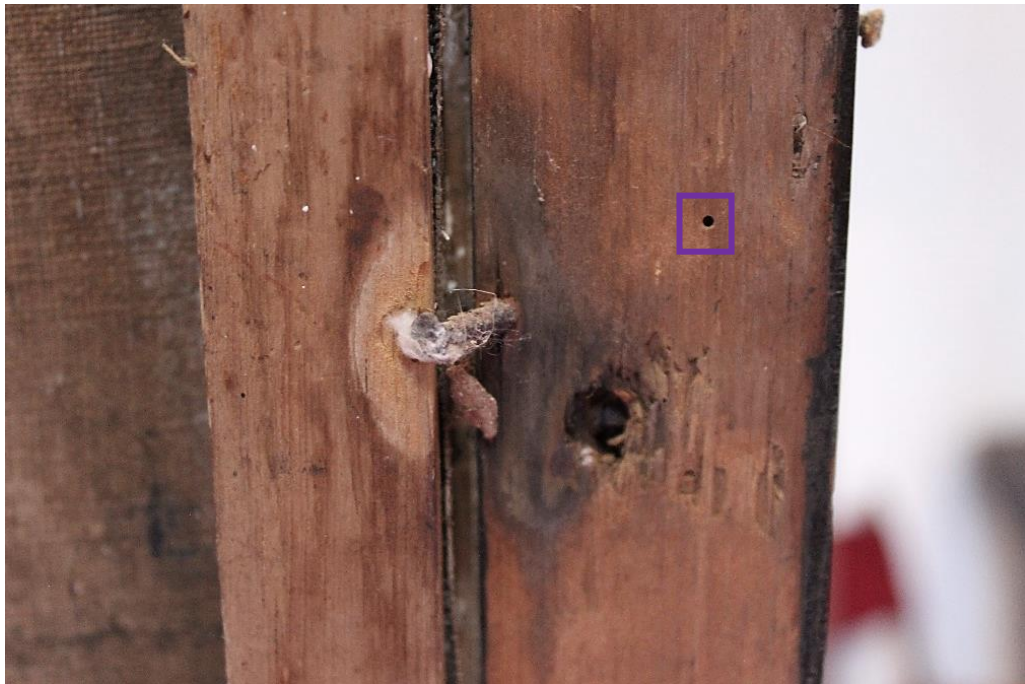
Fig. 72: Ejemplo de falta de soporte por acción de xilófagos
