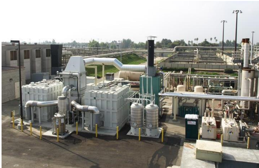
Figura 18: Planta de biogás con implementación de pilas de combustible con una capacidad de 2,8 MW (Chino, 2012)
