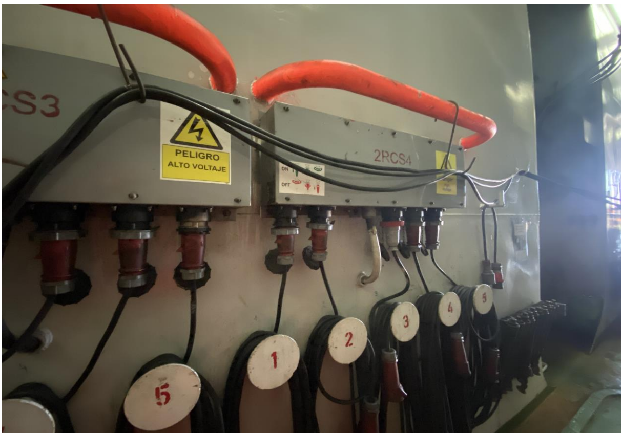
Ilustración 3 toma de corriente para remolques frigoríficos en cubierta principal. Elaboración propia.
