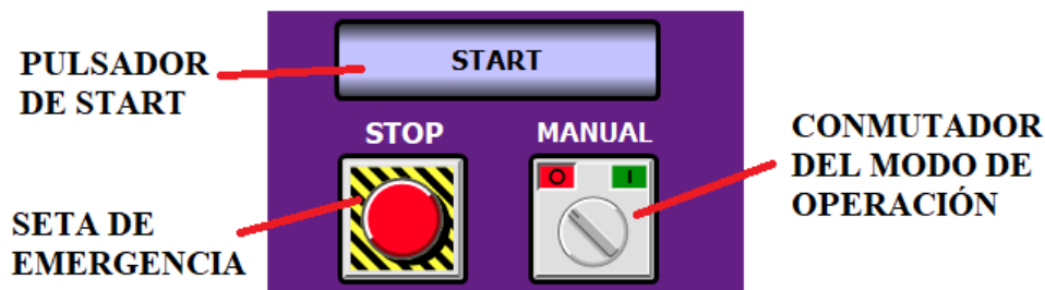
Figura 29. Elementos de control internos
