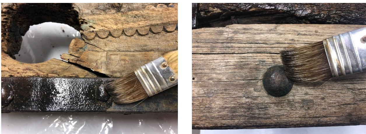
Ilustración 88. Aplicación de inhibidor y posteriormente de protección
