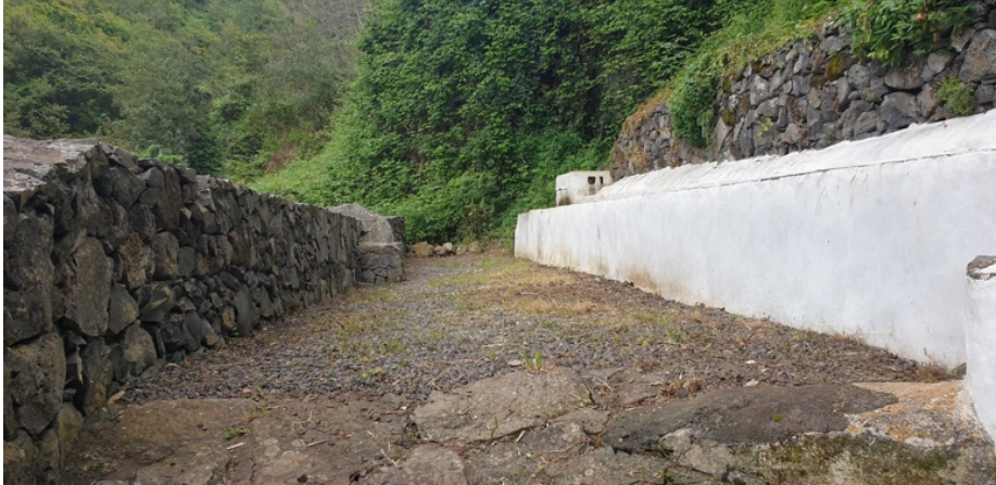
Figura 18: Fotografía de los lavaderos enmarcados en los barrancos Hondo y de Sabujo. Presentan signos de restauración reciente, no obstante, el camino para llegar hasta ellos es bastante deficiente y precisa de un trabajo de limpieza.
