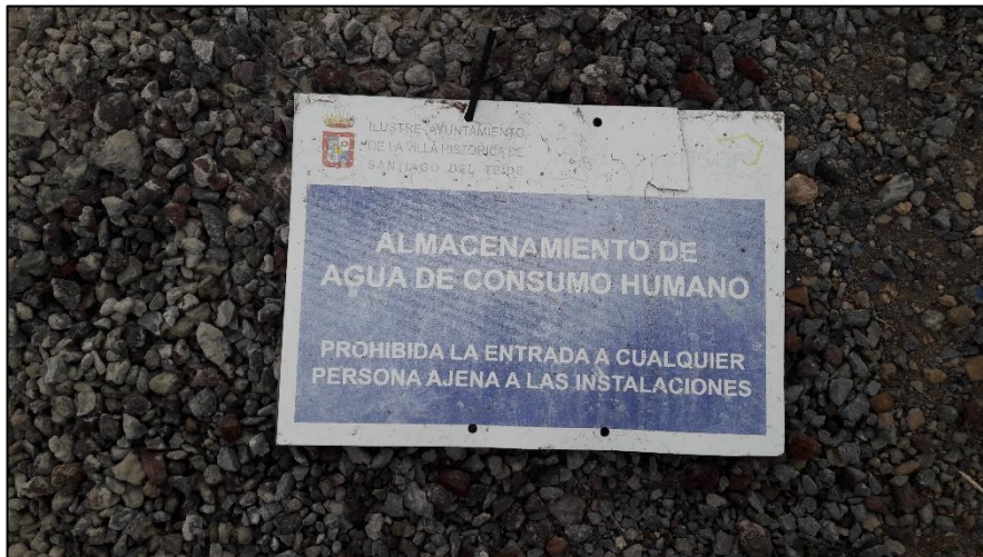
Ilustración 3. Cartelería deteriorada depósito San Francisco.
