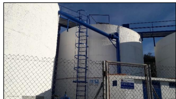
Ilustración 38. Acceso exterior y trámex anticaída.
