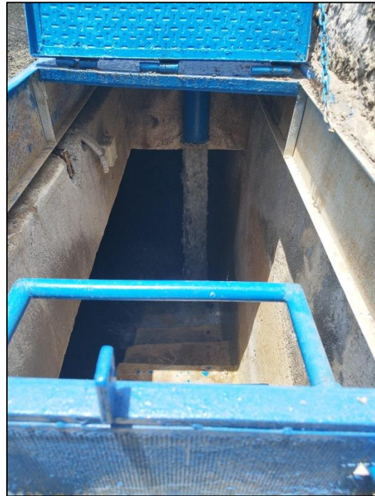
Ilustración 14. Conducción entrada Depósito Hoya Las Piedras 2 superior y Galería los Frontones.
