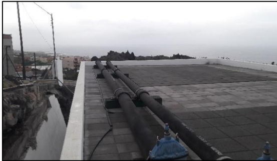
Ilustración 29. Techos limpios y sin zahorra.
