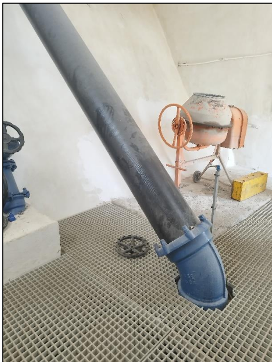
Ilustración 15. Rebosadero Depósito San Francisco.
