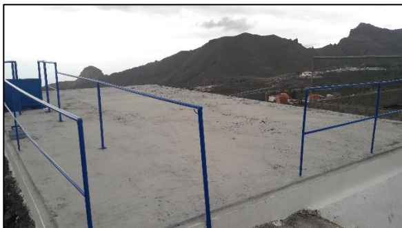
Ilustración 5. Techos impermeabilizados sin pendiente.
