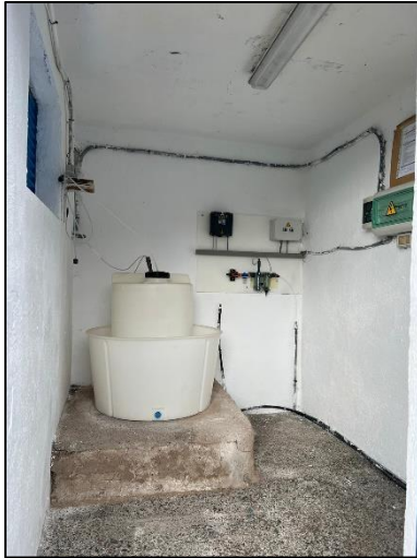
Ilustración 8. Interior cuarto de cloración.
