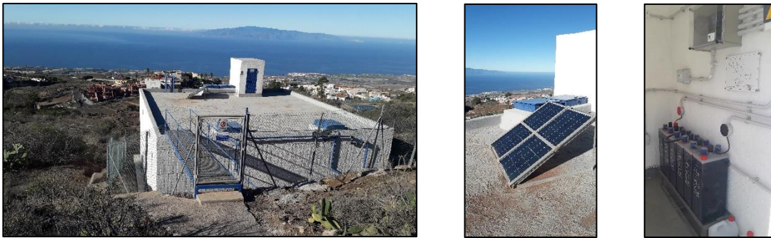
Ilustraciones 54,55 y 56. Sistema de paneles fotovoltaicos.
