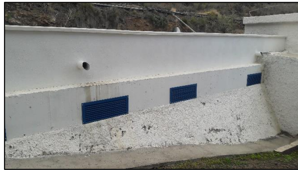
Ilustración 23. Conductos evacuación agua pluvial.
