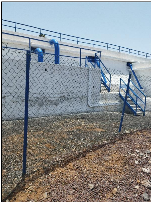
Ilustración 11. Conducciones entrada EDAM Fonsalía (izquierda) y Depósito Hoya Las Piedras 2 (derecha).
