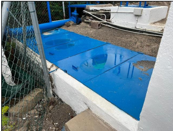
Ilustración 2. Pequeños charcos en los techos del depósito.
