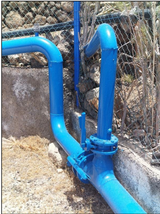
Ilustración 13. Conducción entrada Depósito Hoya Las Piedras 2 superior.
