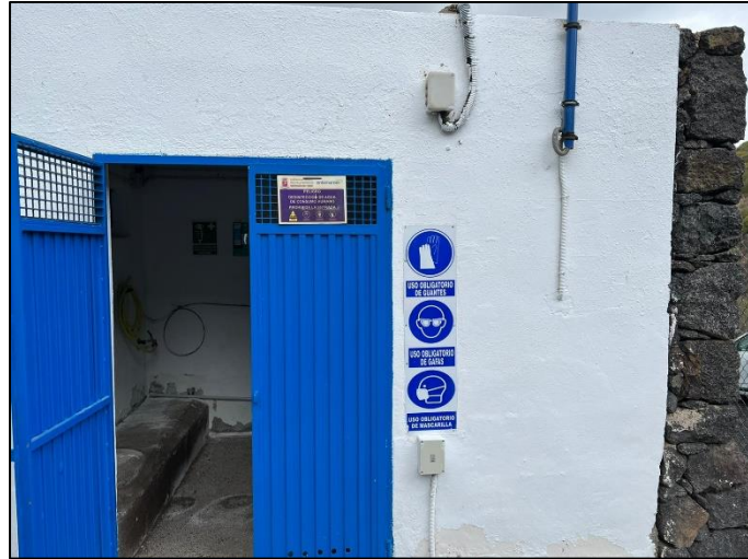
Ilustración 9. Exterior cuarto de cloración.
