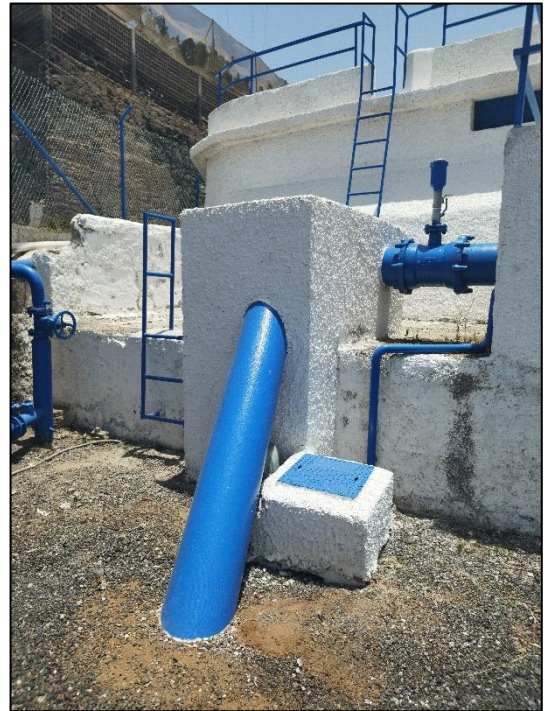
Ilustración 10. Conducción entrada EDAM Fonsalía.
