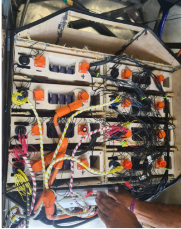
Figura 3.2: Acumulador con 9 módulos de Baterías.
