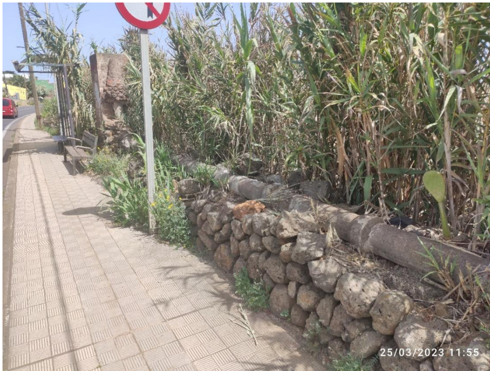
Imagen Nº18. Tubería en desuso, Camino San Miguel de Geneto.
