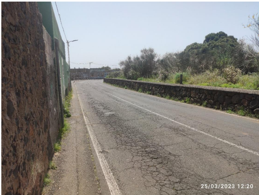
Imagen Nº31. Estado actual de vía, Camino San Bartolomé de Geneto.
