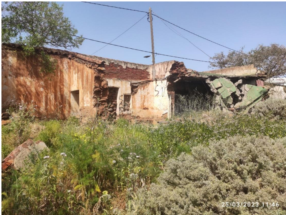
Imagen Nº10. Edificación abandonada, Camino San Miguel de Geneto.
