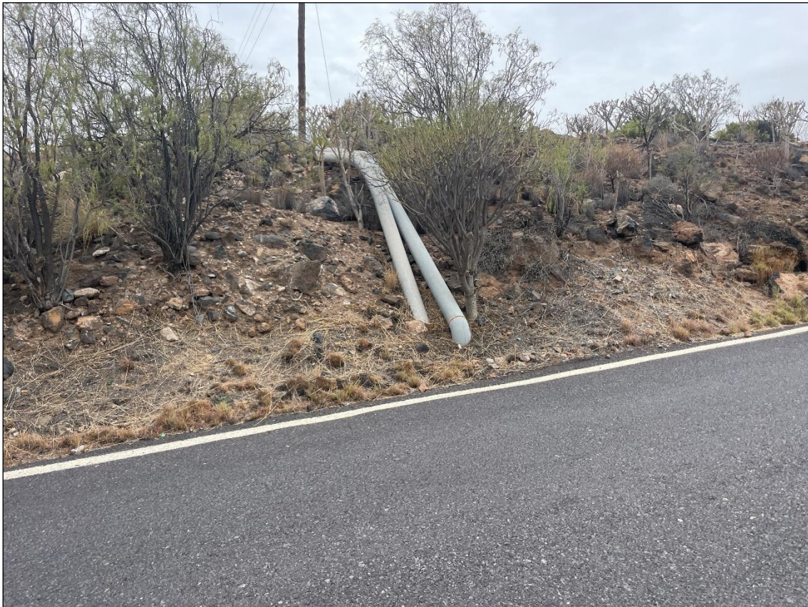
Imagen XVIII. Conducción de agua desalada de EDAM de Granadilla de Abona.
