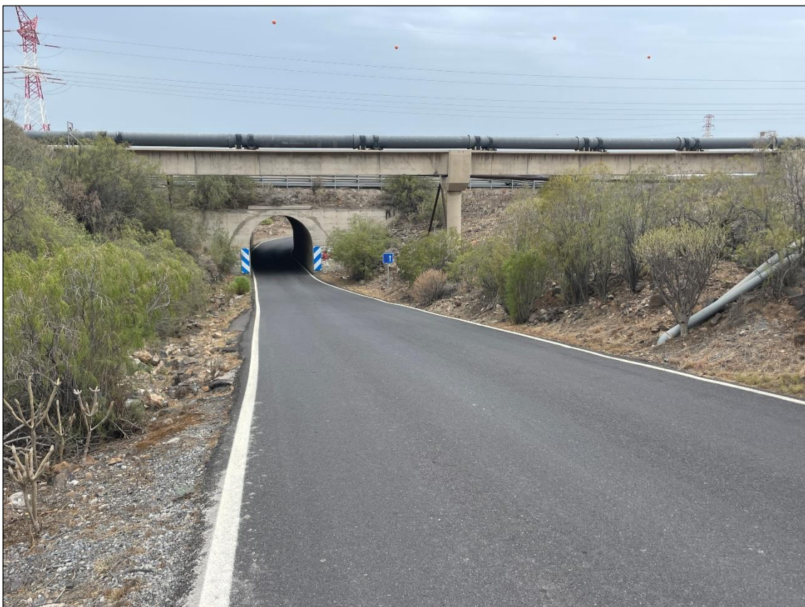
Imagen XIX. Cruce de conducción de agua desalada.
