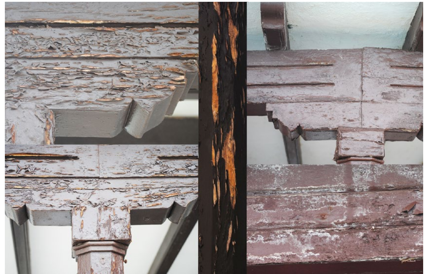
Estado de conservación de una estructura de madera.
