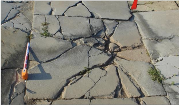
Marcas de impacto por caída de bloques en la plaza del foro en Baelo Claudia (Cádiz) .
