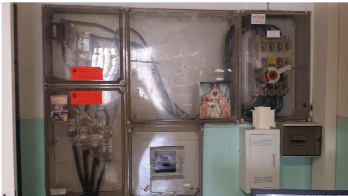
Imagen 6. Punto de conexión de la instalación
