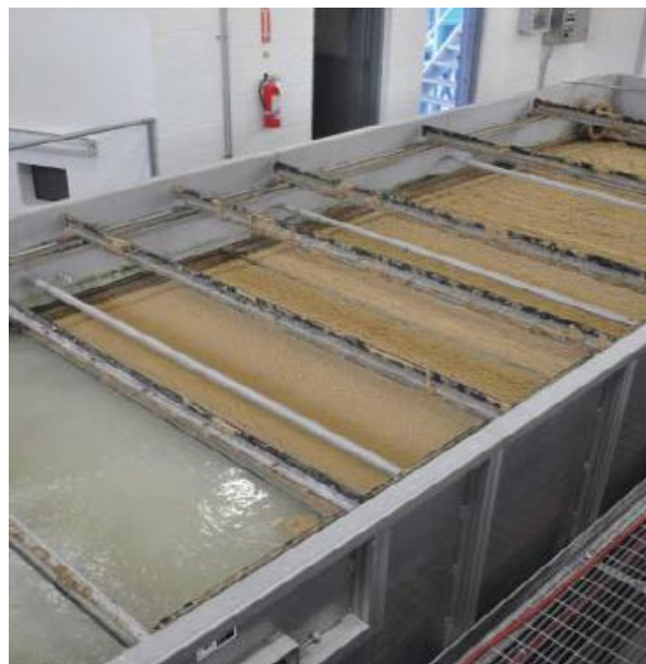
Imagen 34. Instalación de flotación en una desaladora
