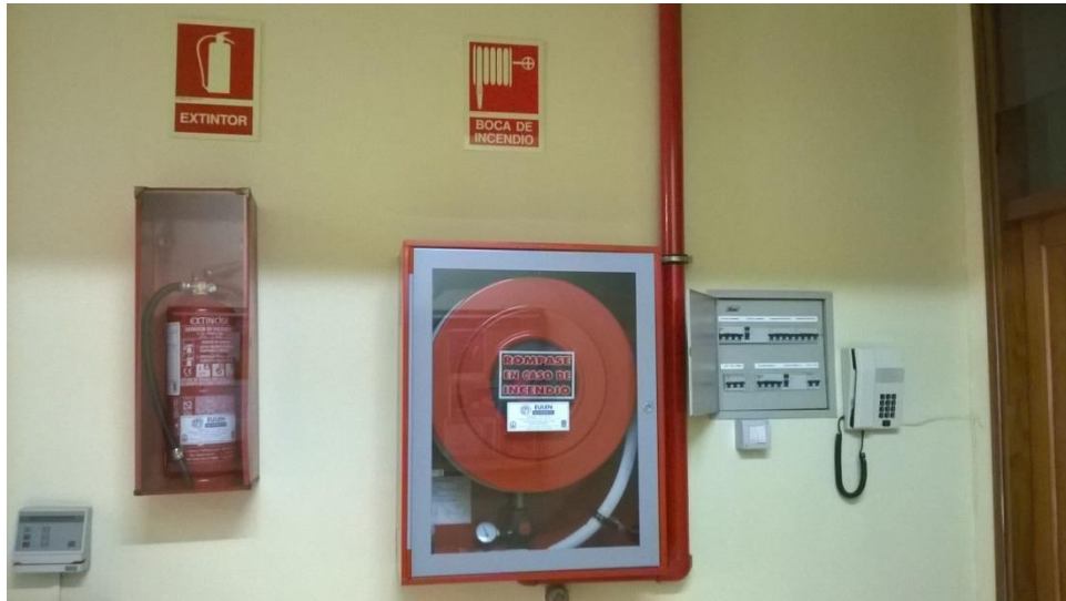
Figura 7: Extintor y boca de incendios en planta baja. Fuente: Elaboración propia.
