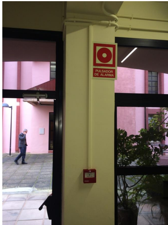
Figura 8: Pulsador emergencia entrada edificio. Fuente: Elaboración propia.
