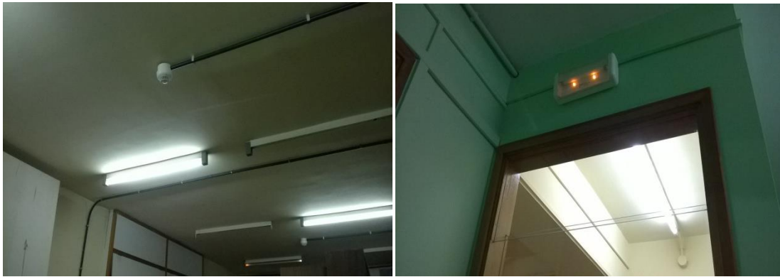
Figura 9: Luces de emergencia y los detectores de humo. Fuente: Elaboración propia.
