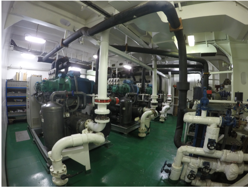
Figura 4.9: Planta de refrigeración
