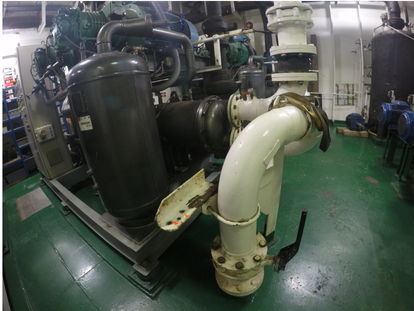
Figura 4.10: Depósito decantador de aceite
