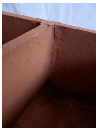
Figura IV.76. Grieta producida en la caja tabicada que se aprecia en el interior pero no profundizó hasta el exterior.
