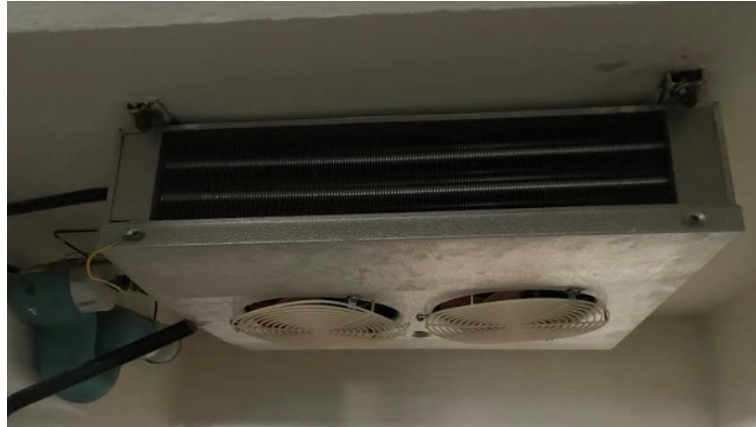
Figura 1.3: Evaporador instalado en la cámara de congelados del taller Fuente: Elaboración propia
