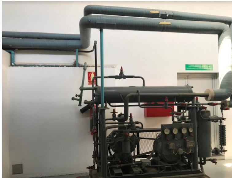
Figura 1.4: Equipos de frío industrial Fuente: Elaboración propia
