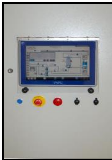
Ilustración Nº28. Cabina de control del PUREBALLAST 3.1.
