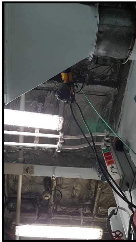
Ilustración N°42. Gancho disponible, para bajar los equipos a la sala de la cámara de bombas.
