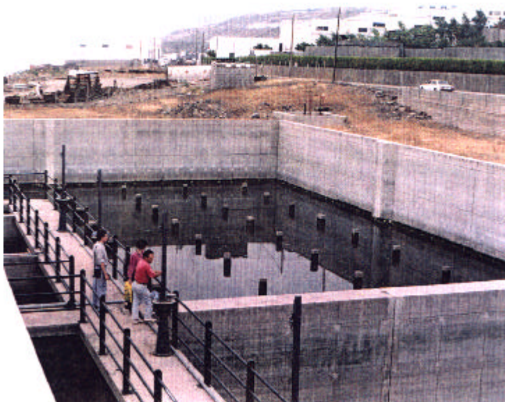
Detalle del Depósito Regulador de Bombeo
