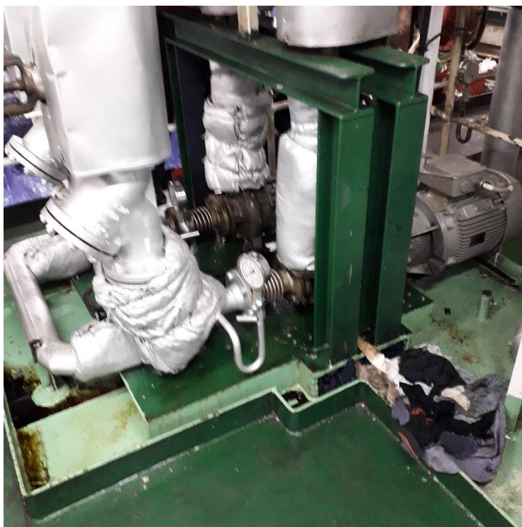
Ilustración 18. Bombas de Circulación. Fuente: Trabajo de campo.
