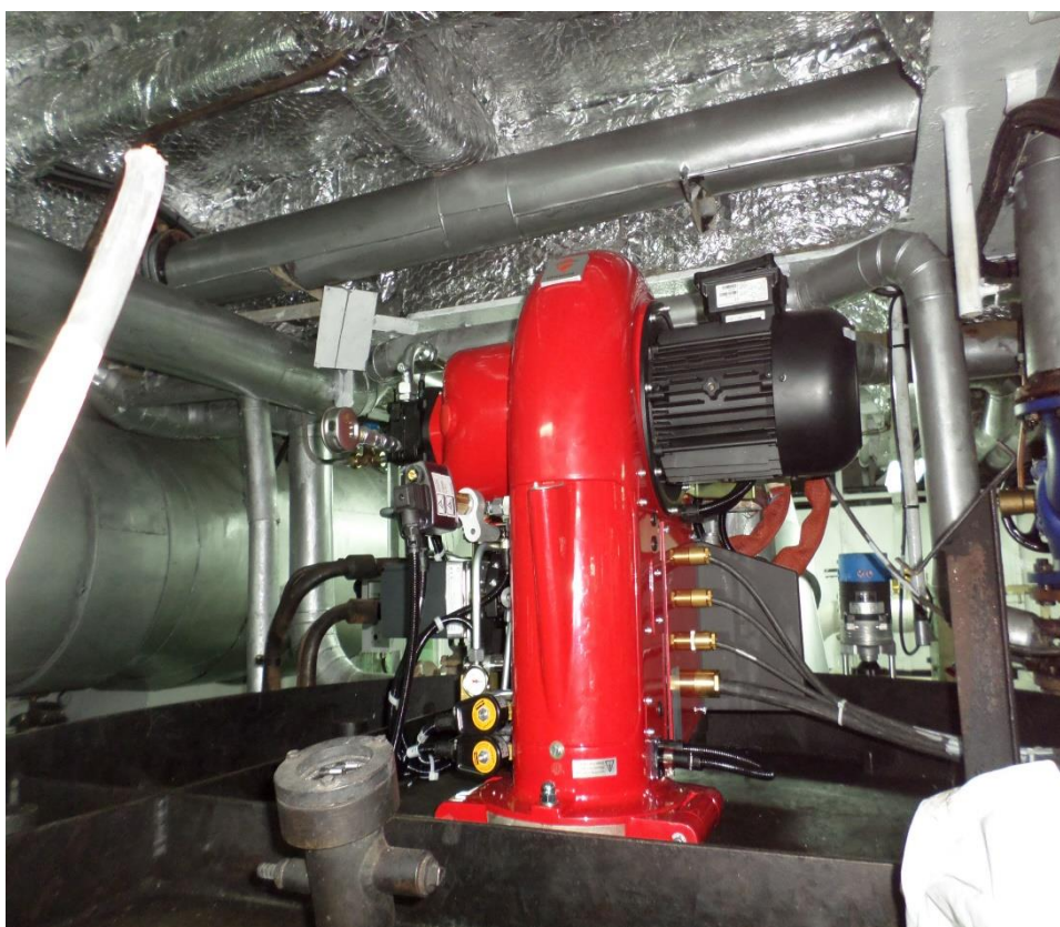
Ilustración 26. Quemador nuevo. Fuente: Trabajo de campo.
