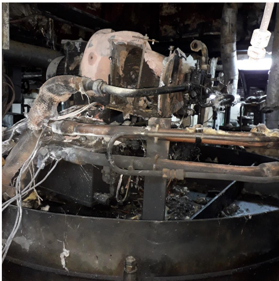
Ilustración 25. Caldera de Combustión averiada. Fuente: Trabajo de Campo.
