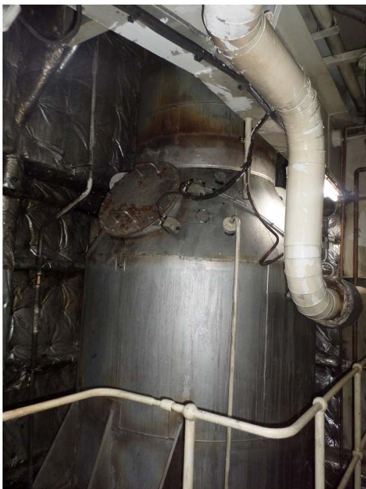
Ilustración 16. Caldera de gases. Fuente: Trabajo de campo.
