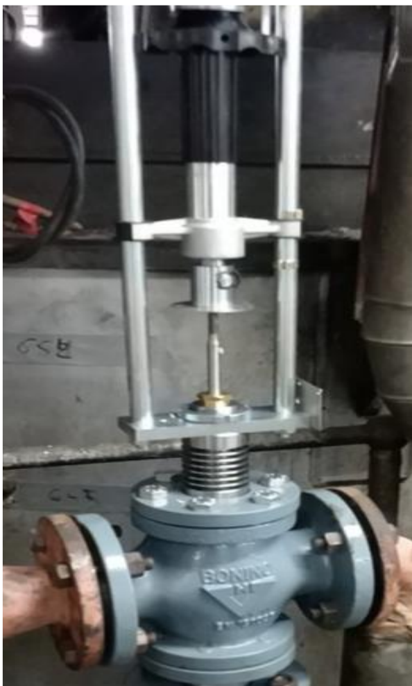
Ilustración 29. Válvula de regulación Dumping cooler. Fuente: Trabajo de campo.
