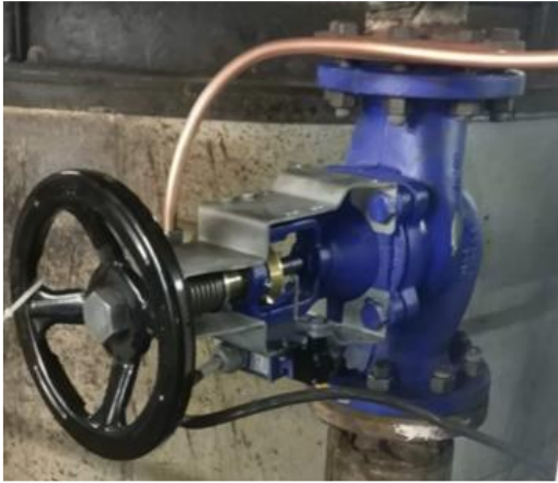
Ilustración 27. Válvula de 2 vías con accionamiento hidráulico. Fuente: Trabajo de campo.
