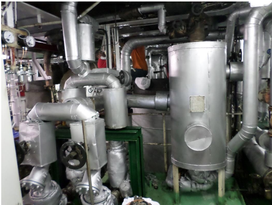
Ilustración 19. Tanque desaireador. Fuente: Trabajo de campo.
