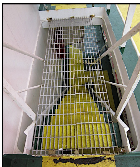
Ilustración 5.7 Escalera exterior asegurada con reja metálica. Loukas I
