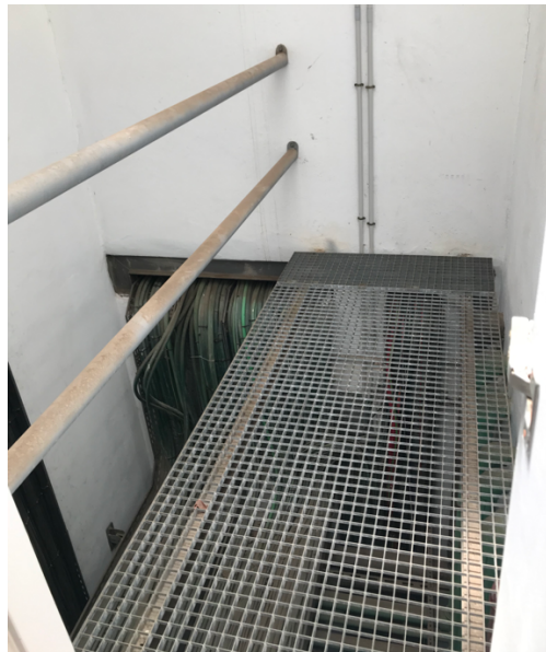
Figura 83. Estructura metálica en hueco de instalaciones y lucernario. Zona - Este de Oficinas.
