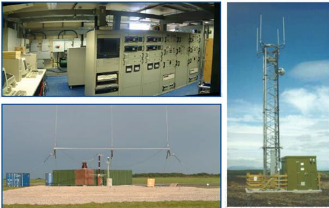
Imagen 3.1 Modernos centros de control y antenas [6]
