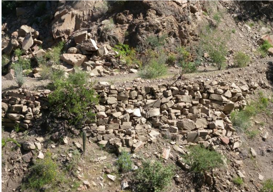
Fotografía 29: Estado actual de una pared de contención, cuya función es impedir corrimientos del firme (tramo alternativo del Camino Real Misionero).
