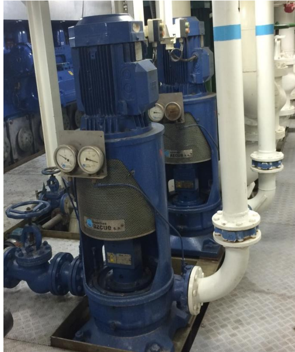
Ilustración 31: Bombas de agua dulce
