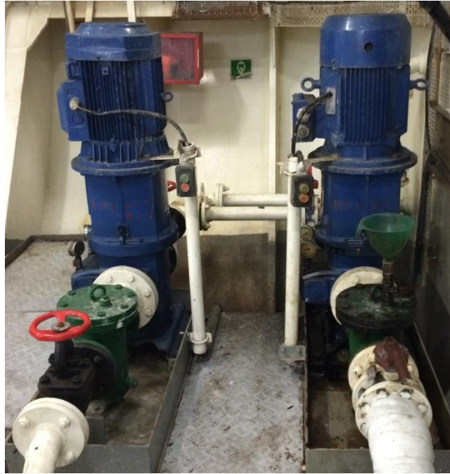
Ilustración 29: Bombas de trasiego de FO y GO
