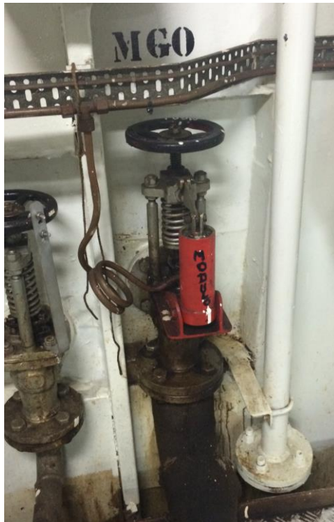
Ilustración 51: Válvula de aspiración tanque 28Br
