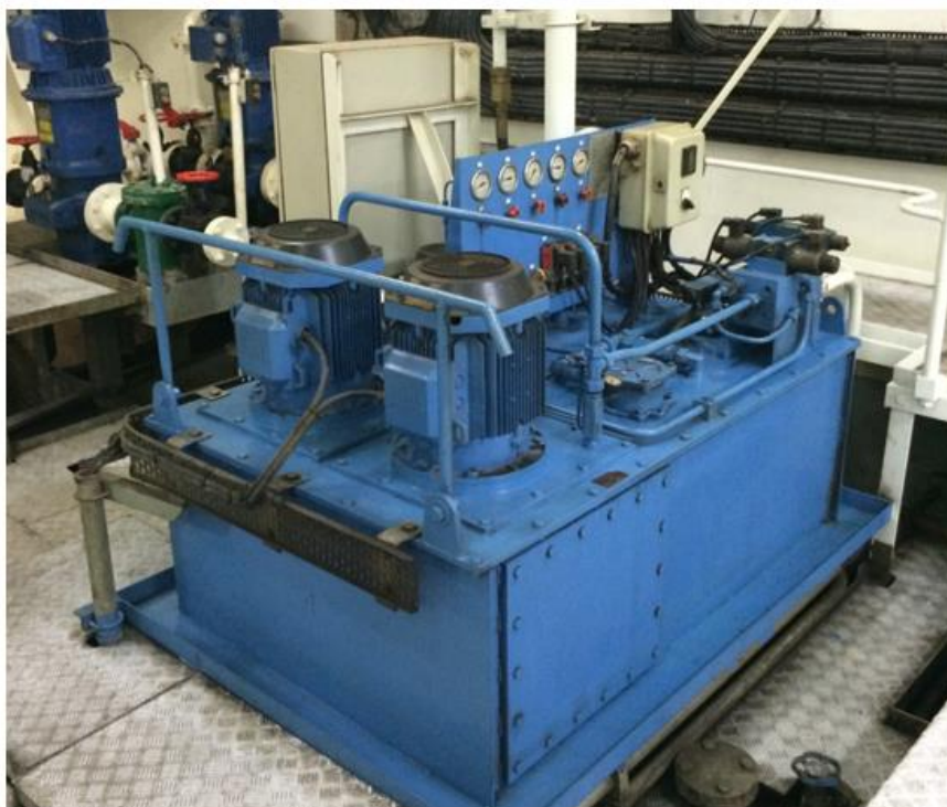
Ilustración 26: Central hidráulica de HPV
