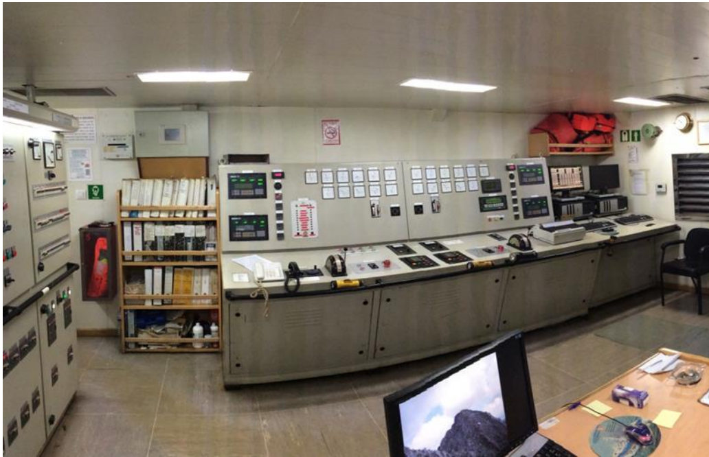
Ilustración 17: Cabina de control de máquinas I
