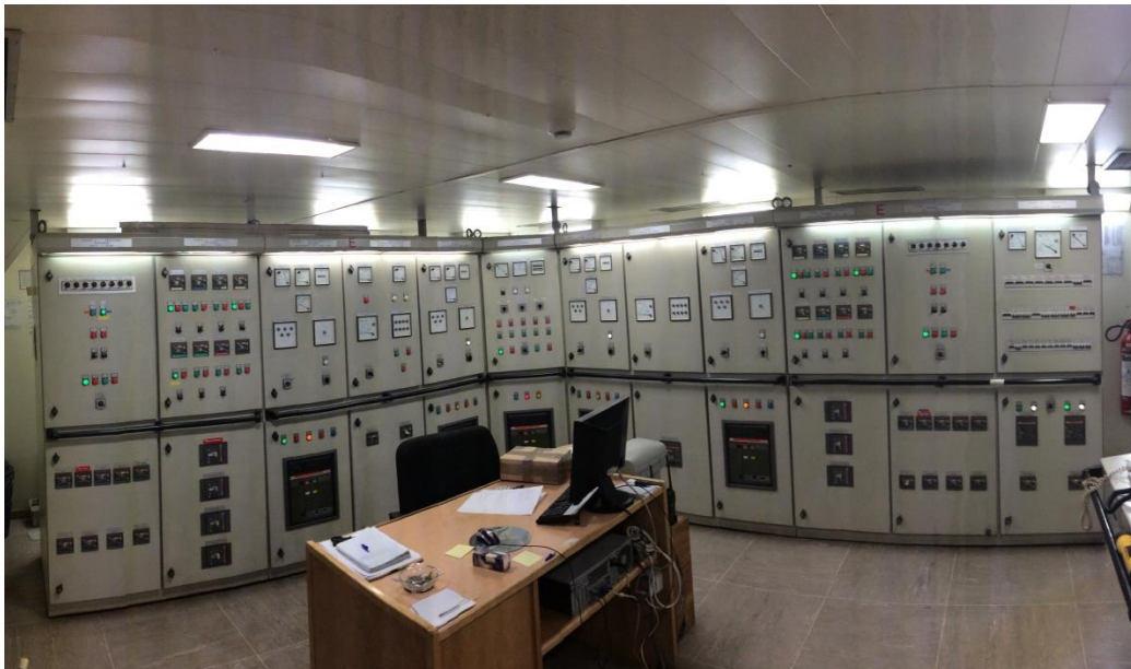
Ilustración 18: Cabina de control de máquinas II
