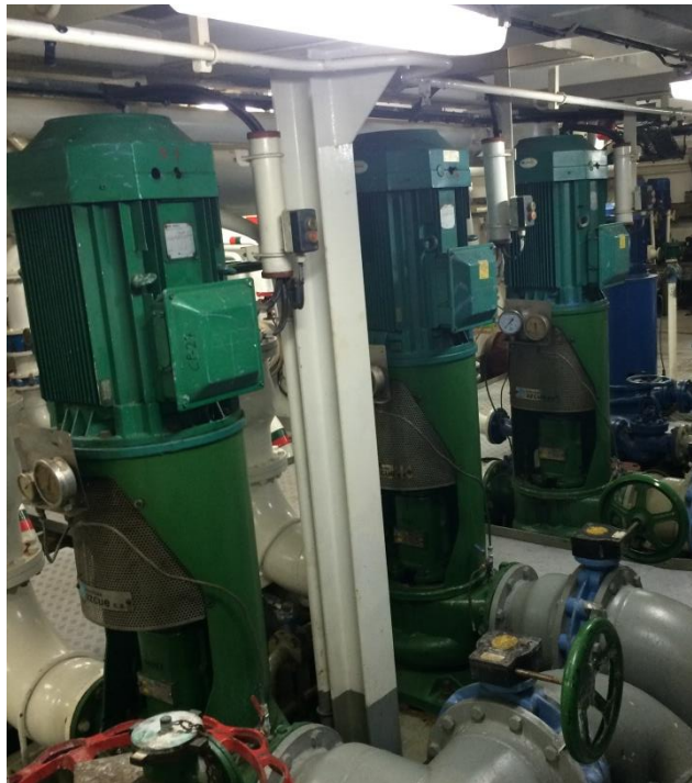
Ilustración 30: Bombas de agua salada
