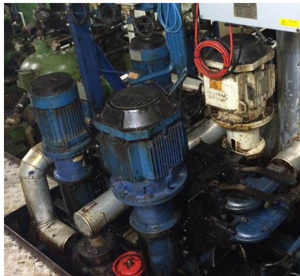
Ilustración 48: Bombas Feeder y Booster del módulo
