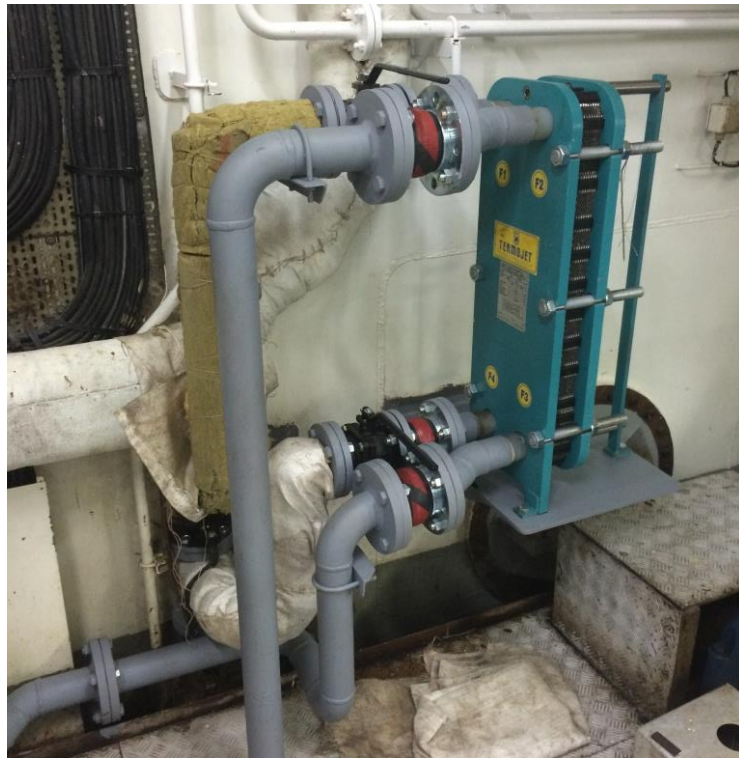
Ilustración 46: Nuevo enfriador de gasoil
