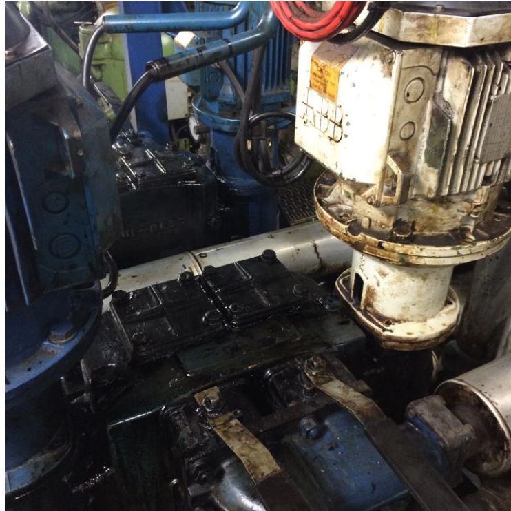
Ilustración 55: Filtros bombas feeder y booster para limpiar
