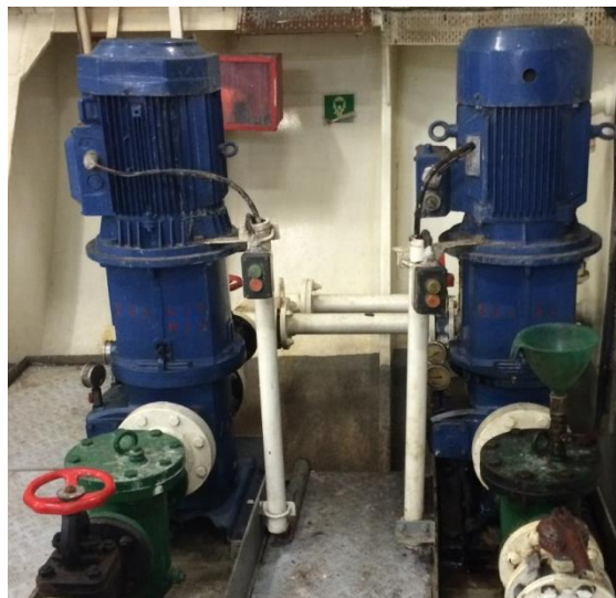
Ilustración 36: Bombas de trasiego de combustible
