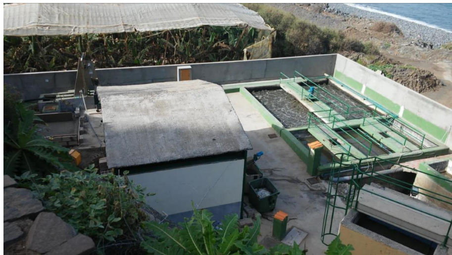
Figura 2.6. EDAR del municipio de Hermigua en 2015. (Ayuntamiento de Hermigua)
