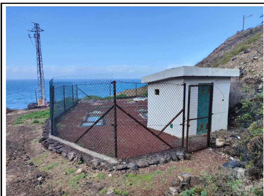
FOTOGRAFÍA 2.- EBAR SAN JUAN DE LA RAMBLA I A LA QUE SE LE REALIZARÁ EL CAMBIO DE BOMBAS
