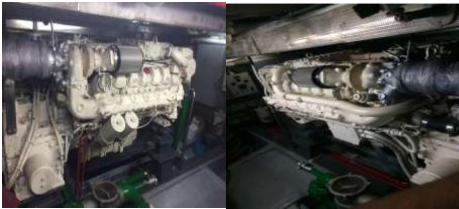
Ilustración 11. Motores principales buque "Gracioso Uno". Fuente: Trabajo de Campo.
