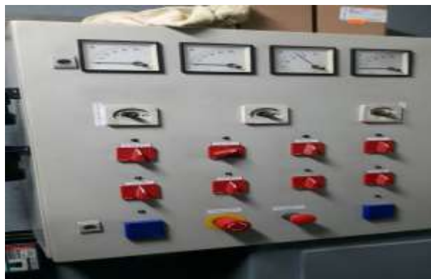
Ilustración 16. Cuadro eléctrico 220V. Fuente: Trabajo de Campo.
