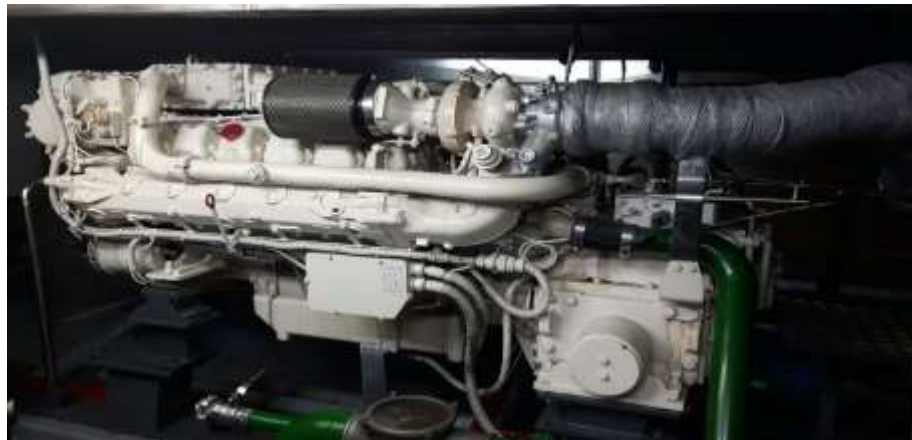
Ilustración 9. Motor principal estribor MAN-D-2842 L 413. Fuente: Trabajo de Campo.
