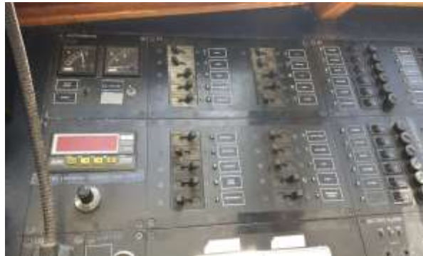
Ilustración 15. Cuadro secundario 24V. Fuente: Trabajo de Campo.
