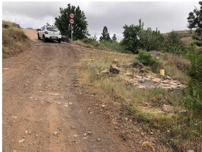
Imagen 13: Zona mal pavimentada.
