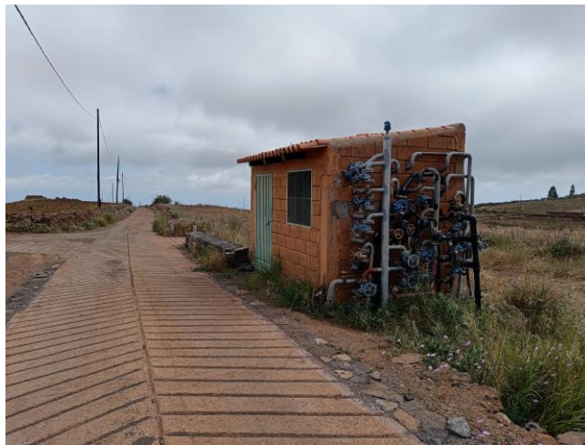
Imagen 9: Caseta de válvulas 2.
