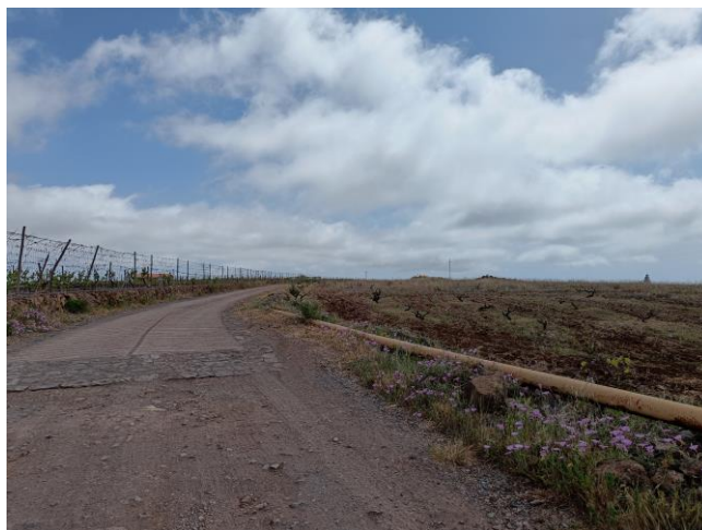
Imagen 5: Inicio zona mal pavimentada.
