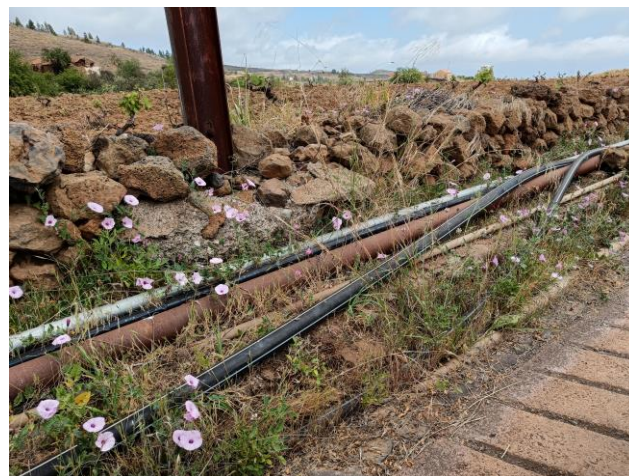
Imagen 8: Tuberías de distribución.
