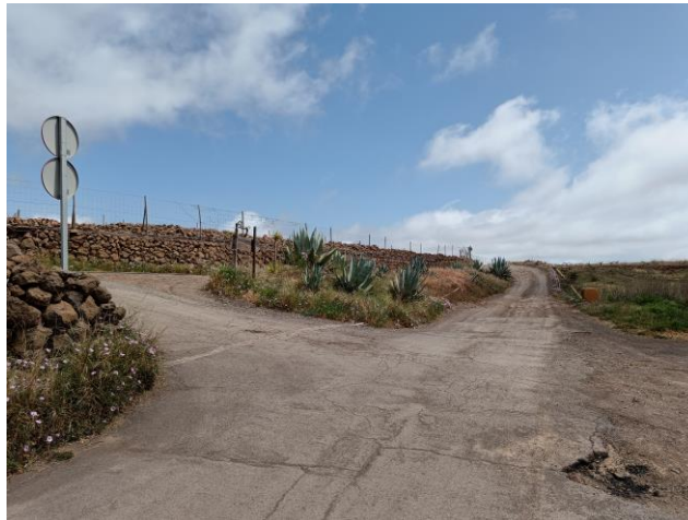
Imagen 6: Zona mal pavimentada.
