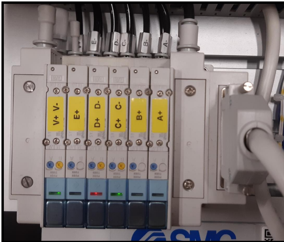
Figura 6.12: Bloque de electroválvulas de la estación FAS-210.
