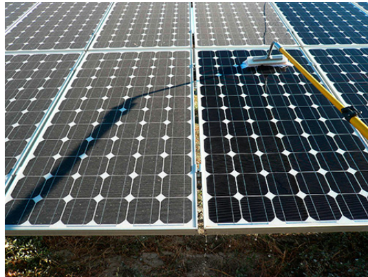
Figura 7.1: Limpieza de módulos fotovoltaicos
