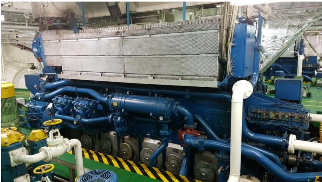
Ilustración 6. Motor principal . Fuente: Trabajo de Campo.
