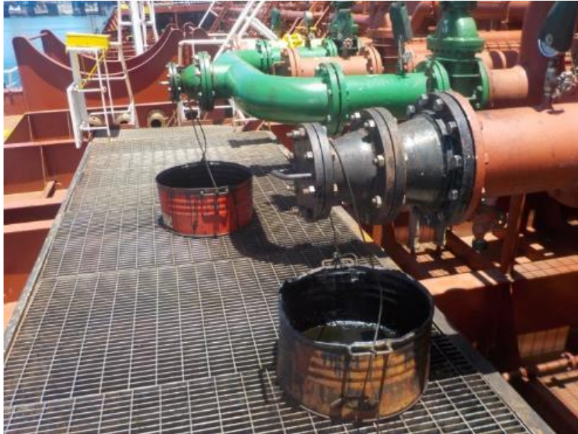
Ilustración 38 Unión de las líneas de los tanques 1s/p – 3s/p (pantalón de manifold de babor). Fuente: Trabajo de Campo.
