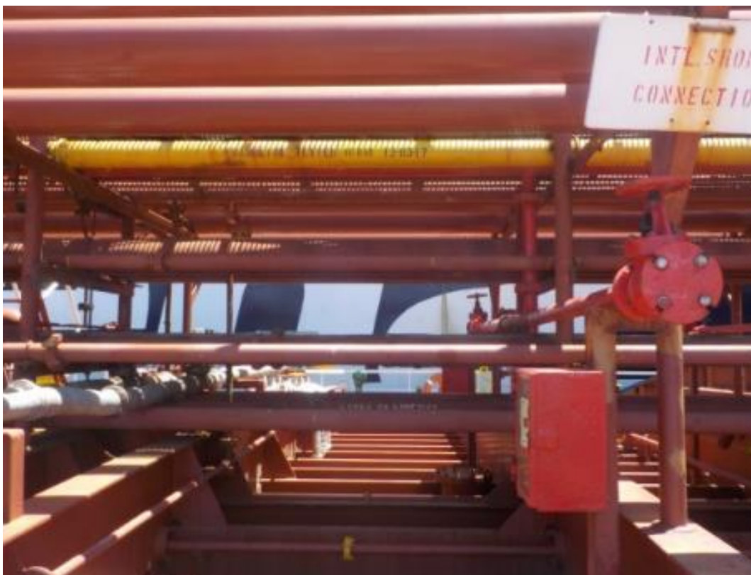
Ilustración 51. Conexión internacional a tierra . Fuente: Trabajo de Campo.
