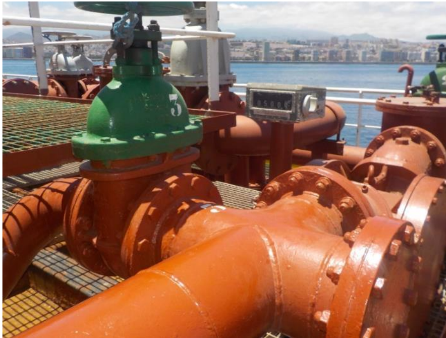
Ilustración 29. Contador de diesel oil . Fuente: Trabajo de Campo.
