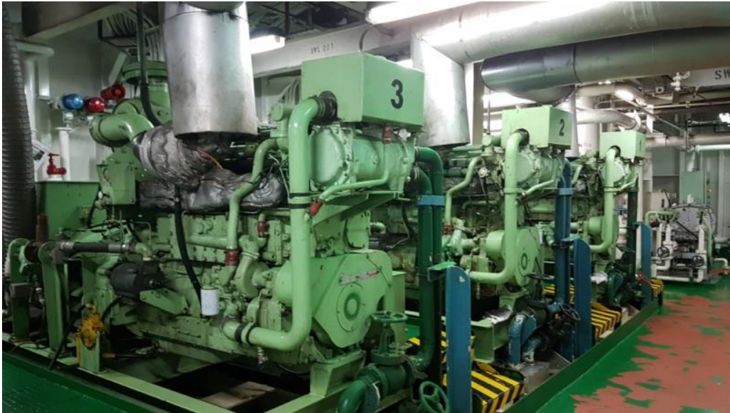
Ilustración 7 motores auxiliares . Fuente: Trabajo de Campo.
