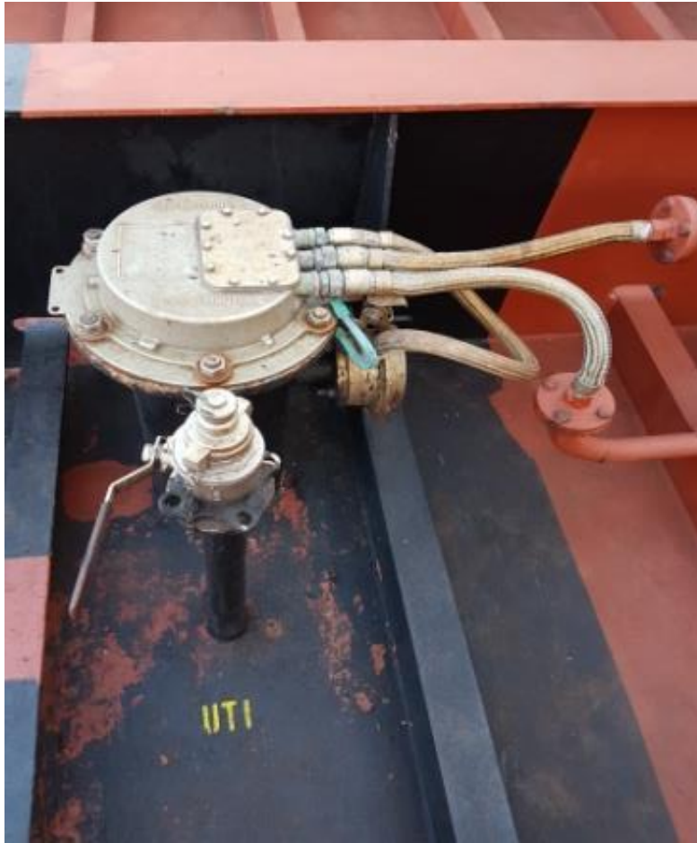
Ilustración 22. Tank Radar. Fuente: Trabajo de Campo.
