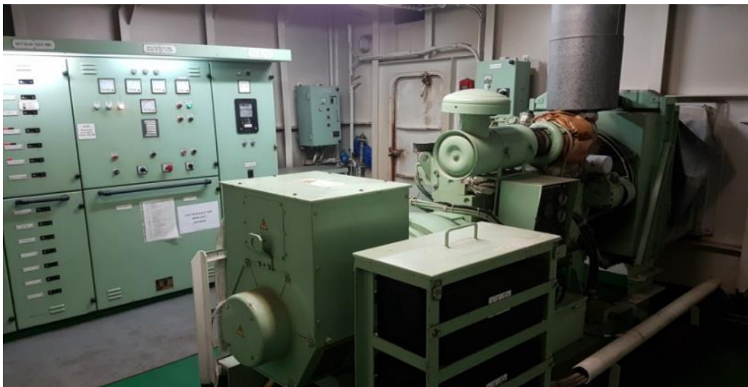
Ilustración 8 Generador de emergencia - Fuente: Trabajo de Campo.
