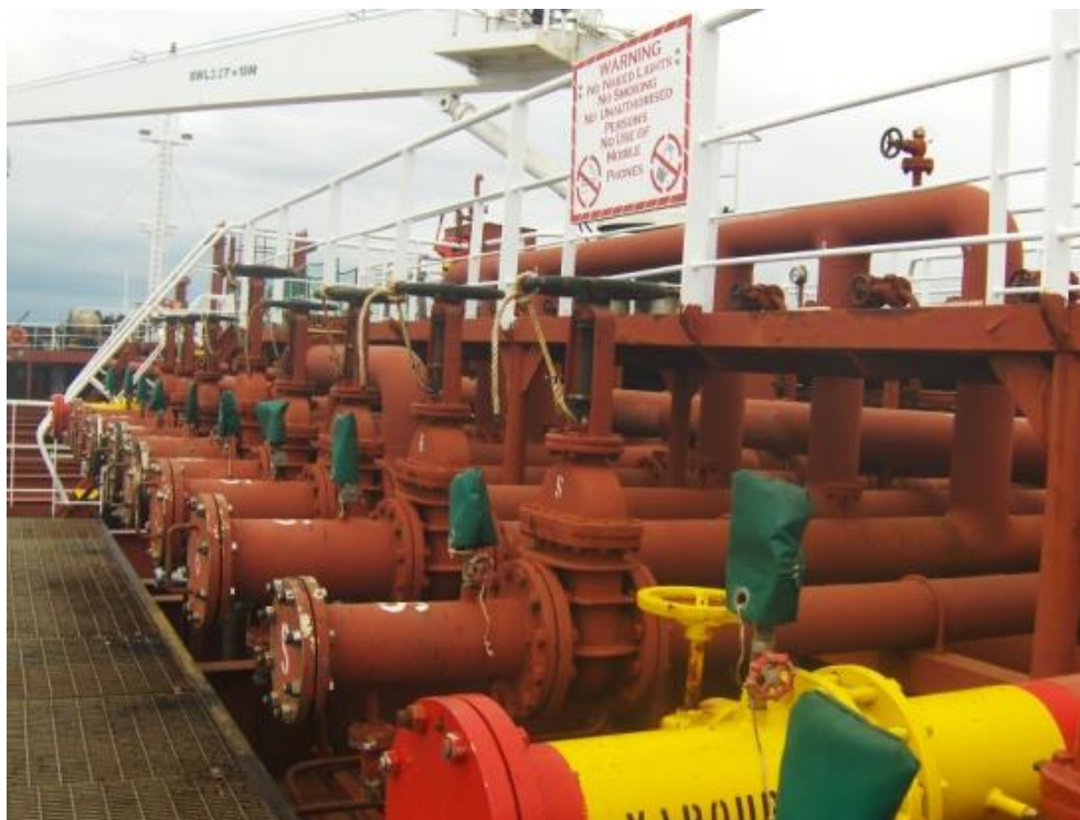
Ilustración 33 manifold central . Fuente: Trabajo de Campo.
