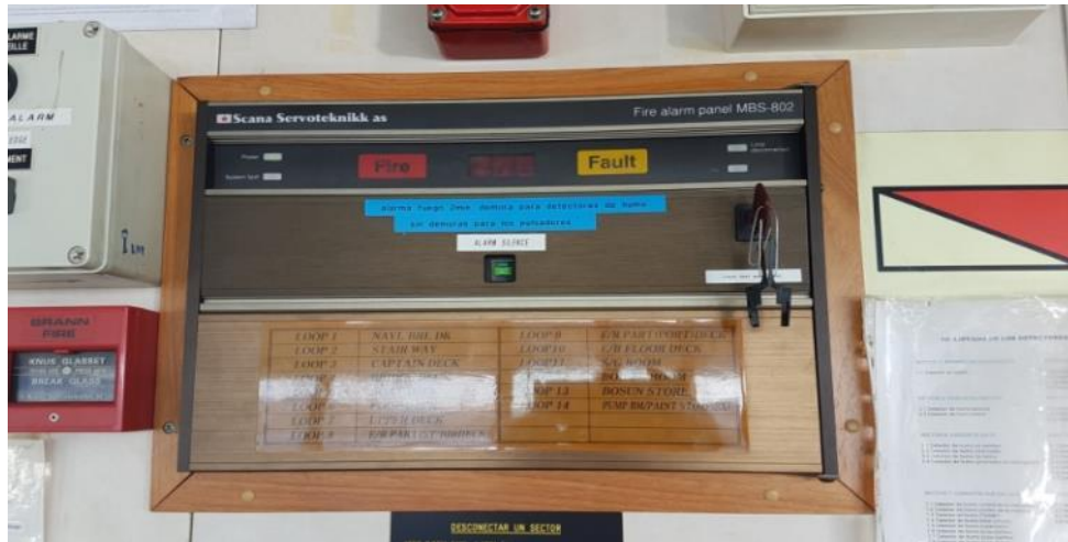
Ilustración 49. Panel de alarmas. Fuente: Trabajo de Campo.
