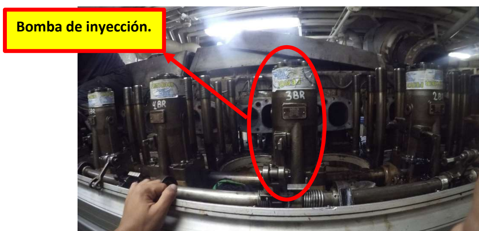
Ilustración 28. Detalle bomba de inyección. Fuente: Trabajo de campo.
