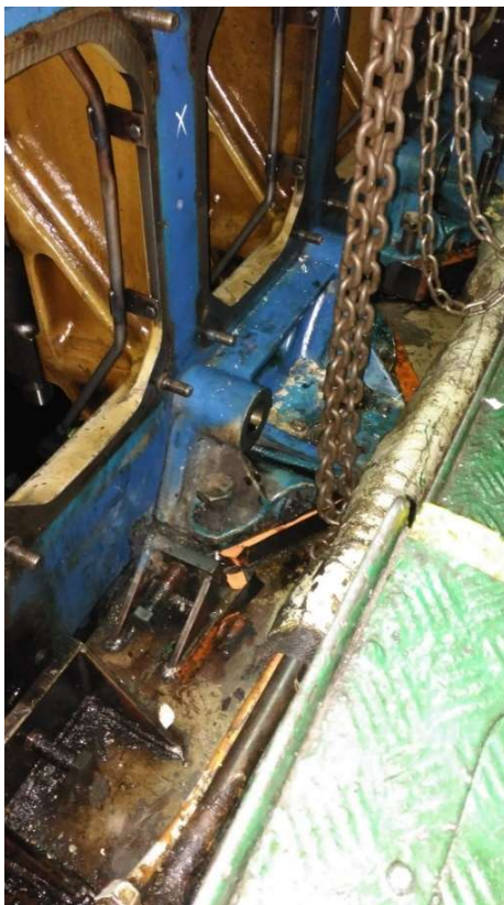
Ilustración 63. Detalle de los tacos del bloque motor. Fuente: Trabajo de campo.
