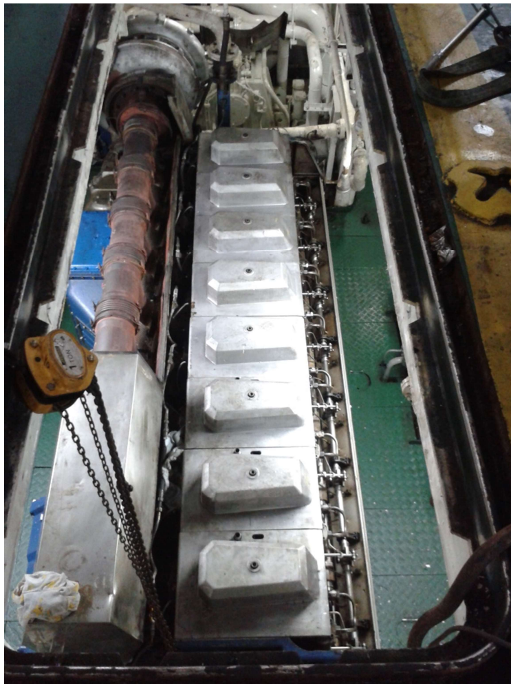
Ilustración 15. Vista desde lumbra motor 8L26. Fuente: Trabajo de campo.
