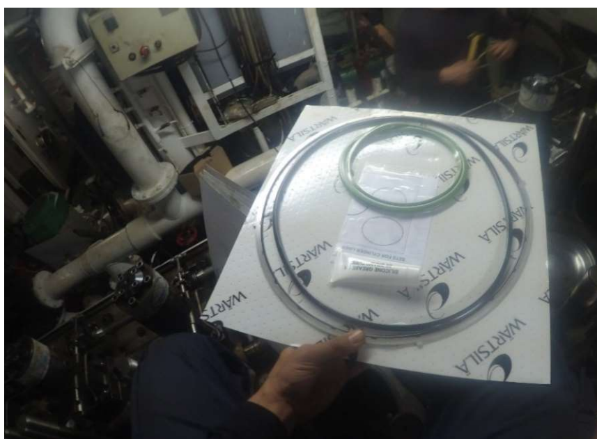
Ilustración 44. Juntas y sellador de las camisas. Fuente: Trabajo de campo.
