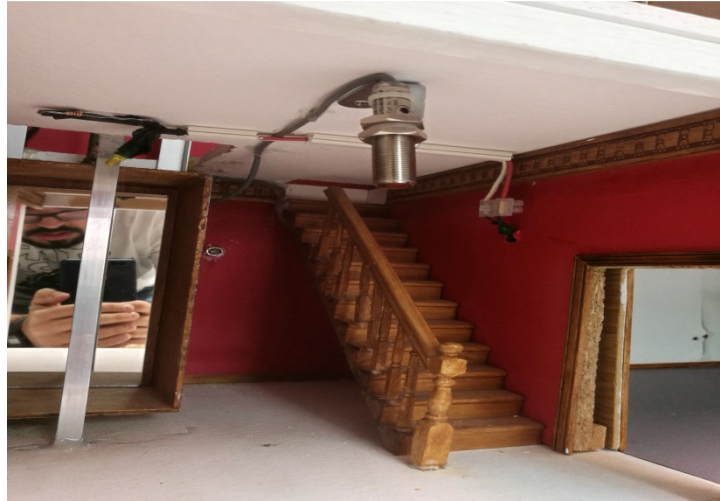
Figura 4.20. Sensor fotoeléctrico en rellano
