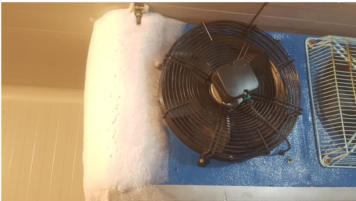
Figura A.1: Hielo formado junto a uno de los ventiladores del evaporador Fuente: Elaboración propia
