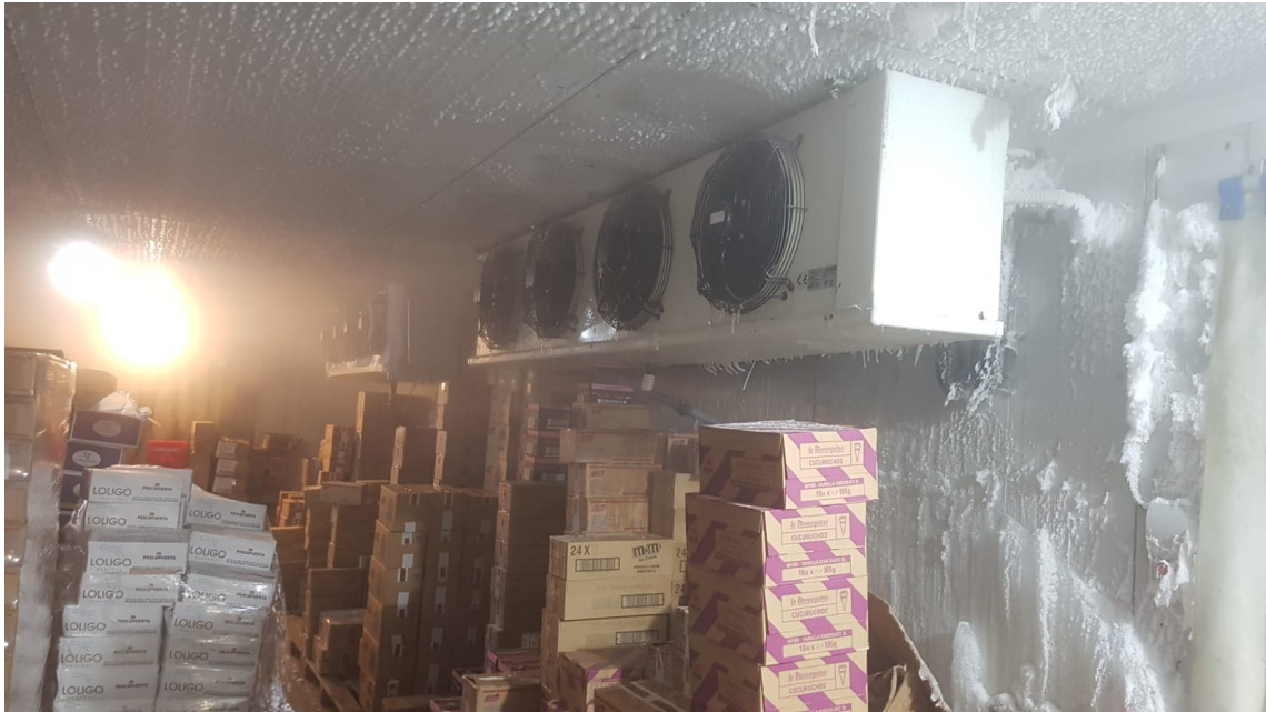
Figura A.4: Cámara helados y congelados Fuente: Elaboración propia
