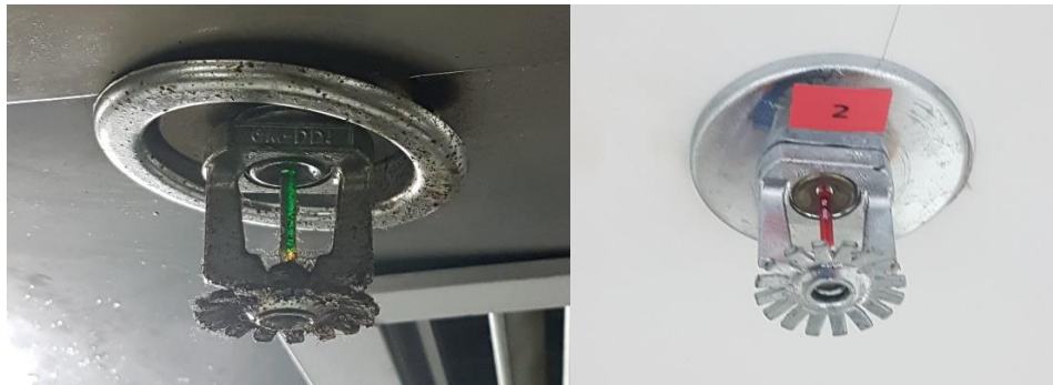
Ilustración 6. Sprinklers. Fuente Propia.
