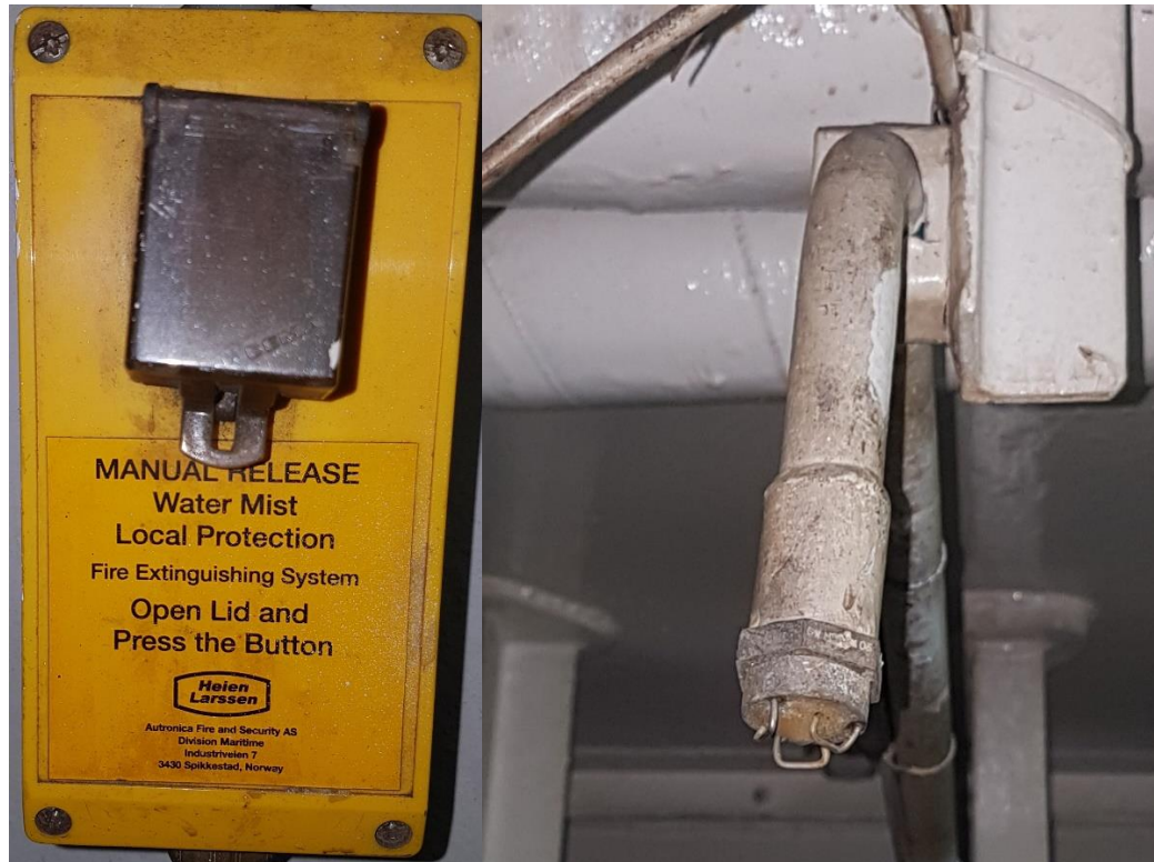
Ilustración 21. Pulsador de activación y Rociador del sistema de aplicación local. Fuente Propia.
