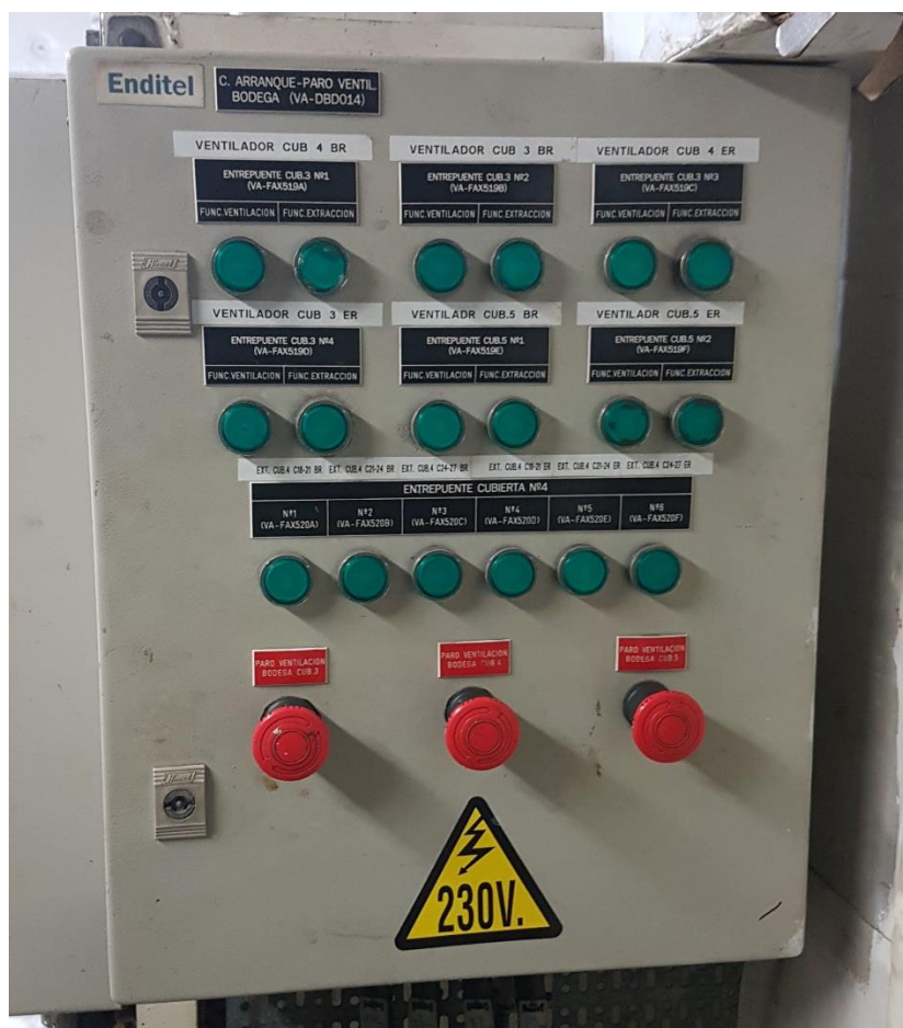
Ilustración 43. Panel de Control de Ventilaciones del Garaje. Fuente Propia.
