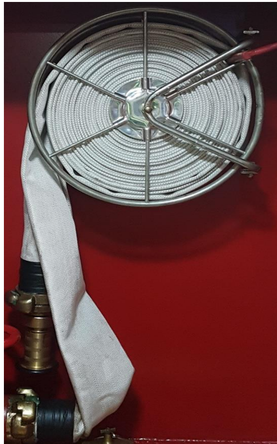
Ilustración 15. Manguera y Devanadora. Fuente Propia.
