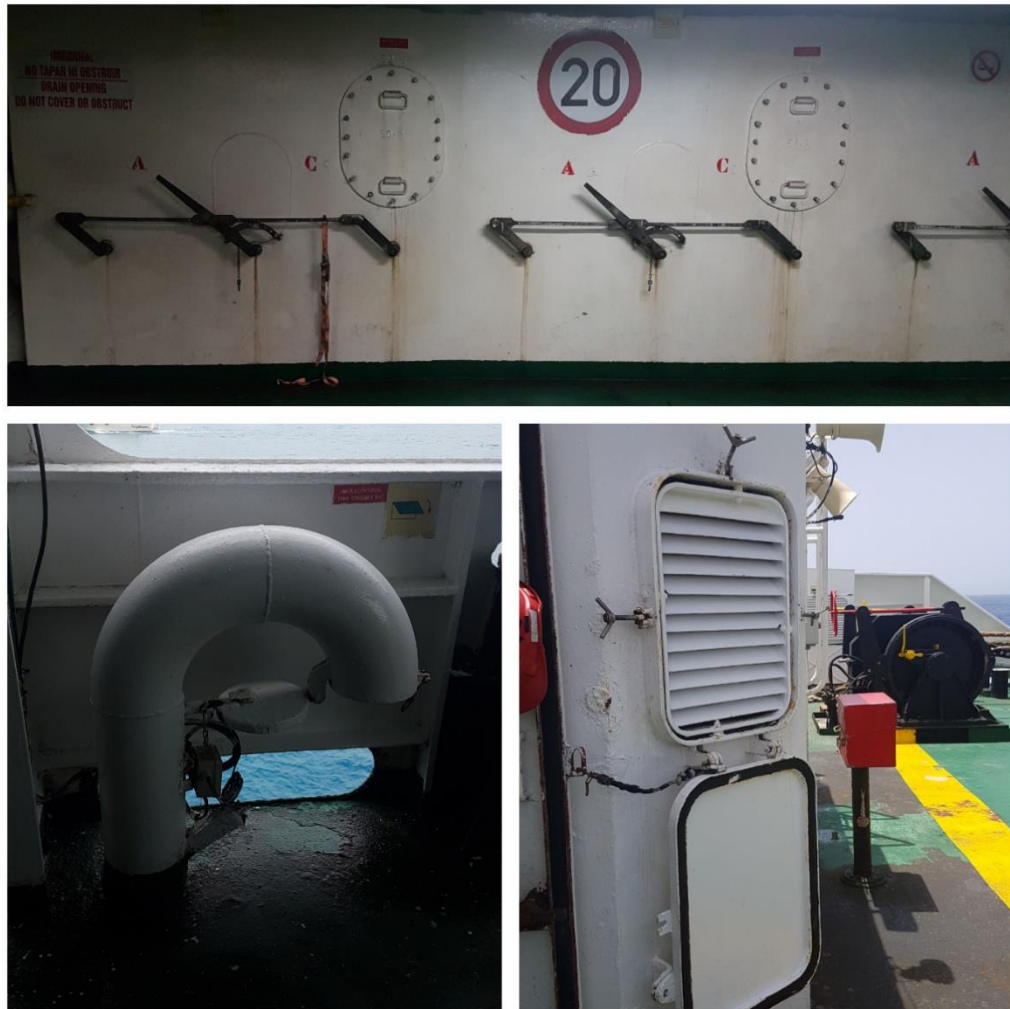
Ilustración 45. Pantallas Cortafuegos Manuales. Fuente Propia.
