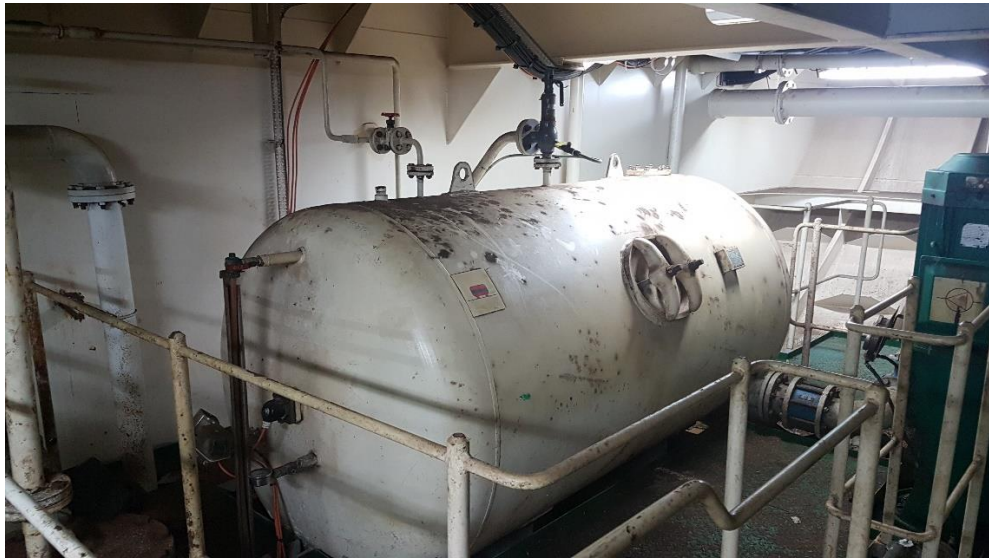
Ilustración 10. Tanque de Sprinklers. Fuente Propia.
