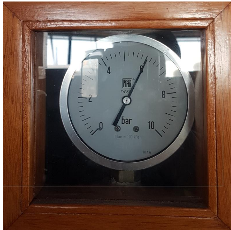
Ilustración 12. Manómetro de la línea de Sprinklers. Fuente Propia.
