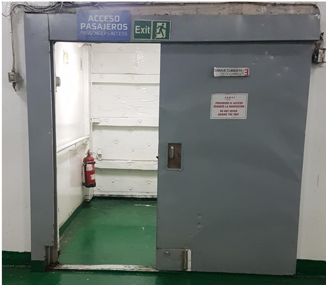
Ilustración 41. Puerta Contra Incendios. Fuente Propia.
