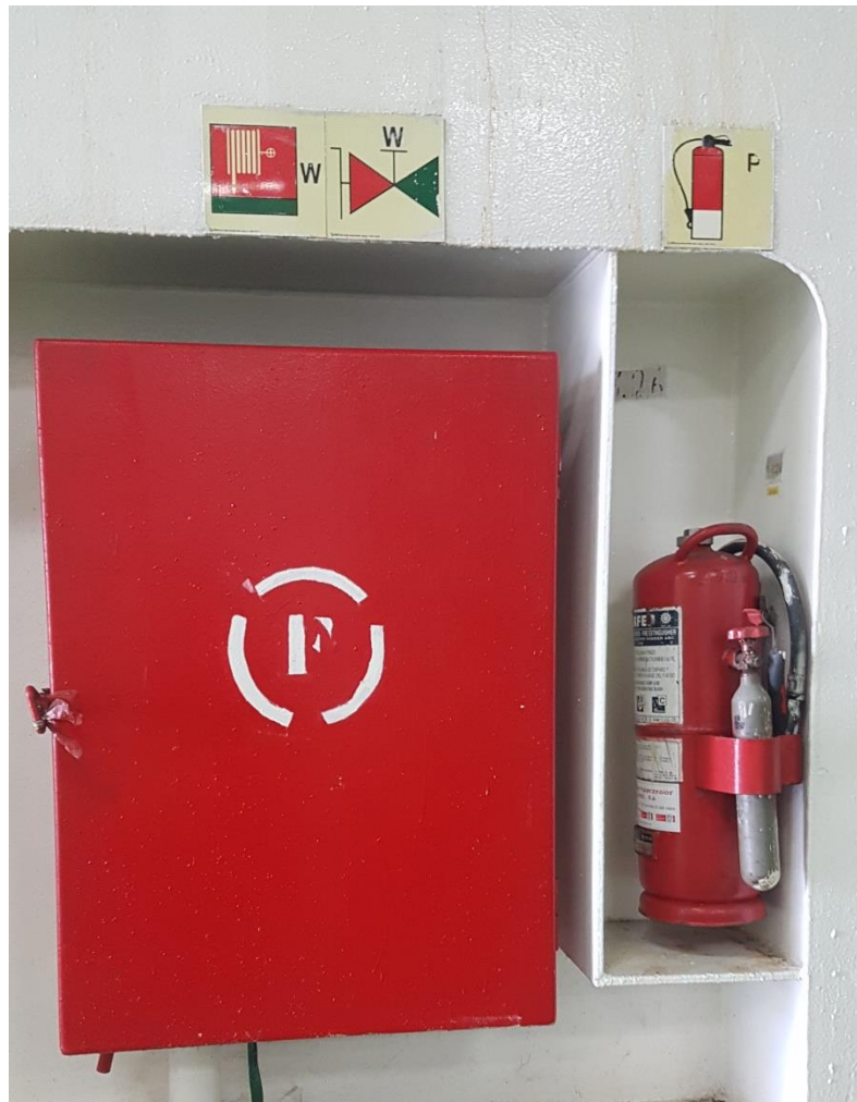
Ilustración 13. Caja Contraincendios. Fuente Propia.
