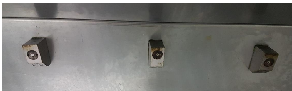
Ilustración 26. Sistema de extinción de la freidora. Fuente Propia.
