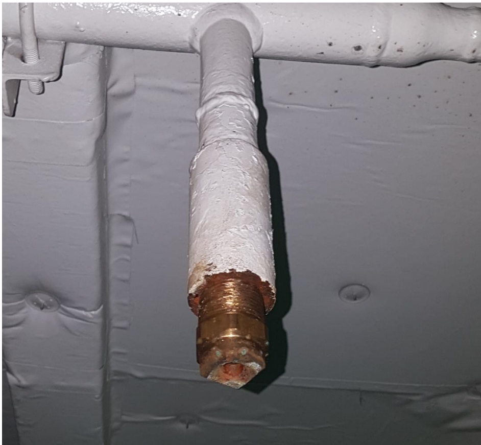
Ilustración 5. Boquilla de Rociador de Garaje. Fuente Propia.
