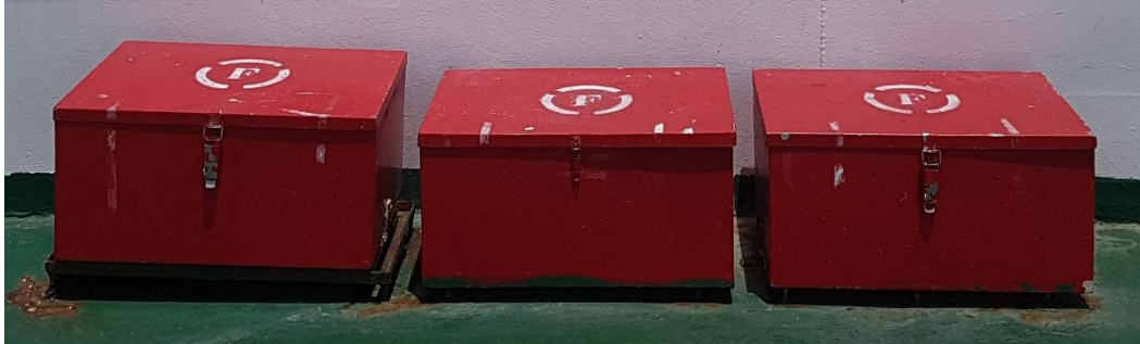
Ilustración 37. Estaciones Contraincendios. Fuente Propia.
