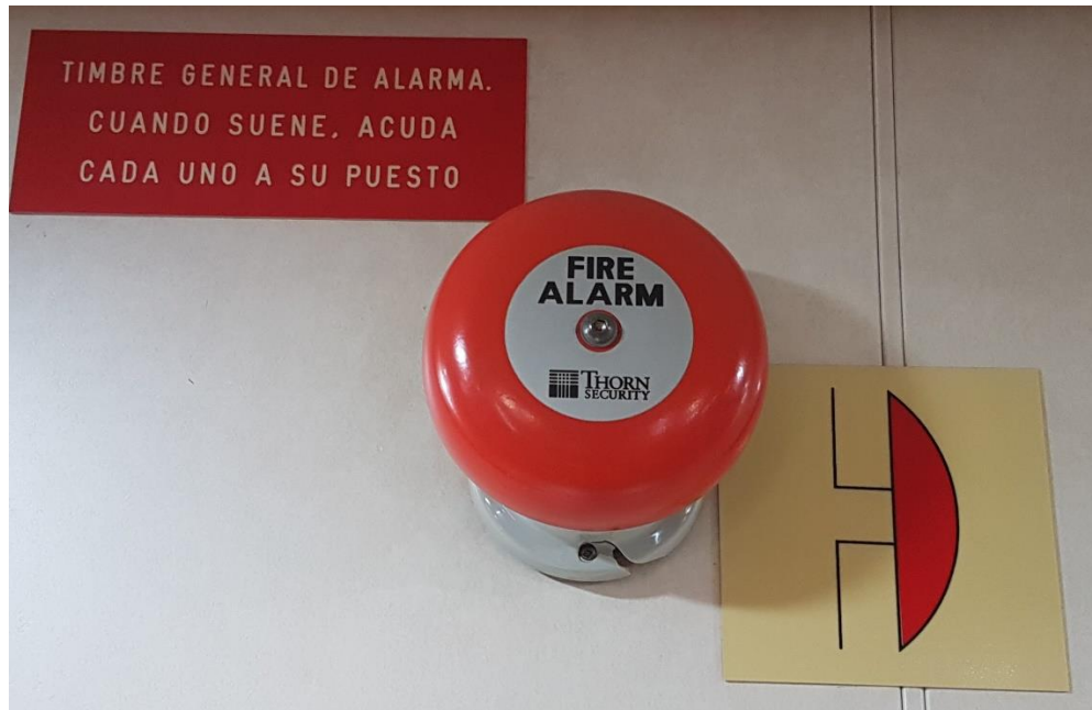
Ilustración 31. Timbre de Alarma General. Fuente Propia.
