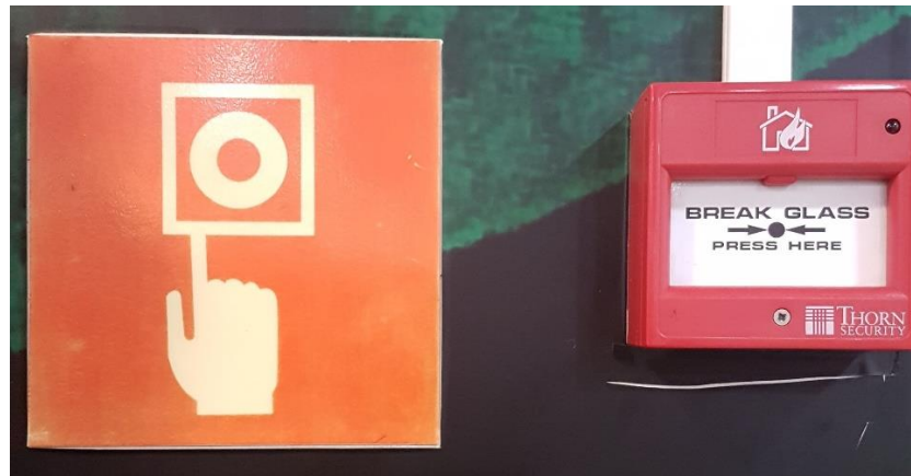
Ilustración 32. Pulsador de Alarma. Fuente Propia.
