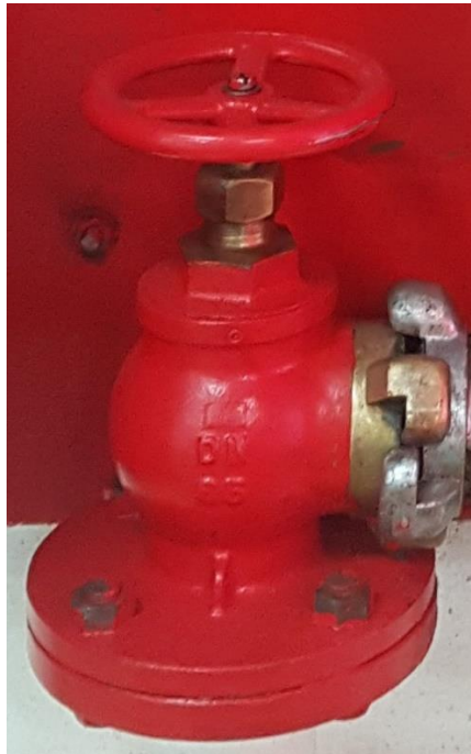
Ilustración 18. Hidrante. Fuente Propia.
