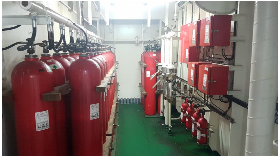
Ilustración 22. Local de CO 2 de la máquina. Fuente Propia.
