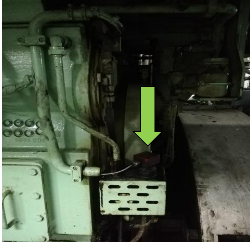
Ilustración 24: Tanque de fugas de cajas calientes
