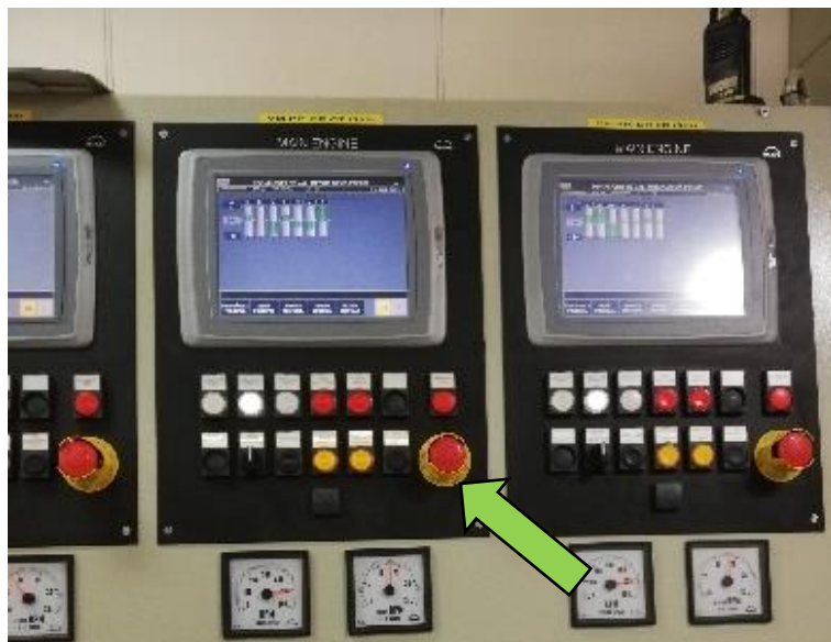
Ilustración 17: Panel de operación remoto
