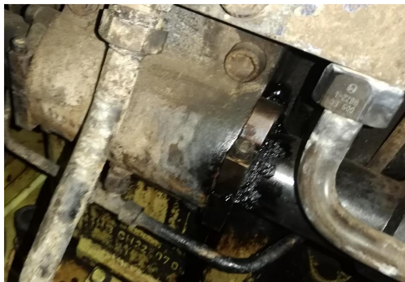
Ilustración 19: Conexión tubería de combustible a la bomba
