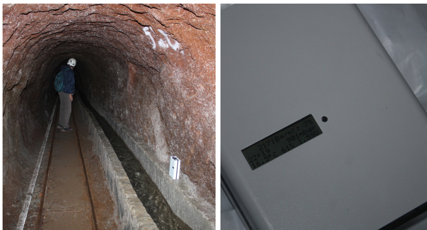
Figura 14. Detector activo colocado en una galería (izq.), este tipo de detectores necesitan un tiempo para poder facilitar una primera lectura (der.). Fuente: Santamarta, J.C.
