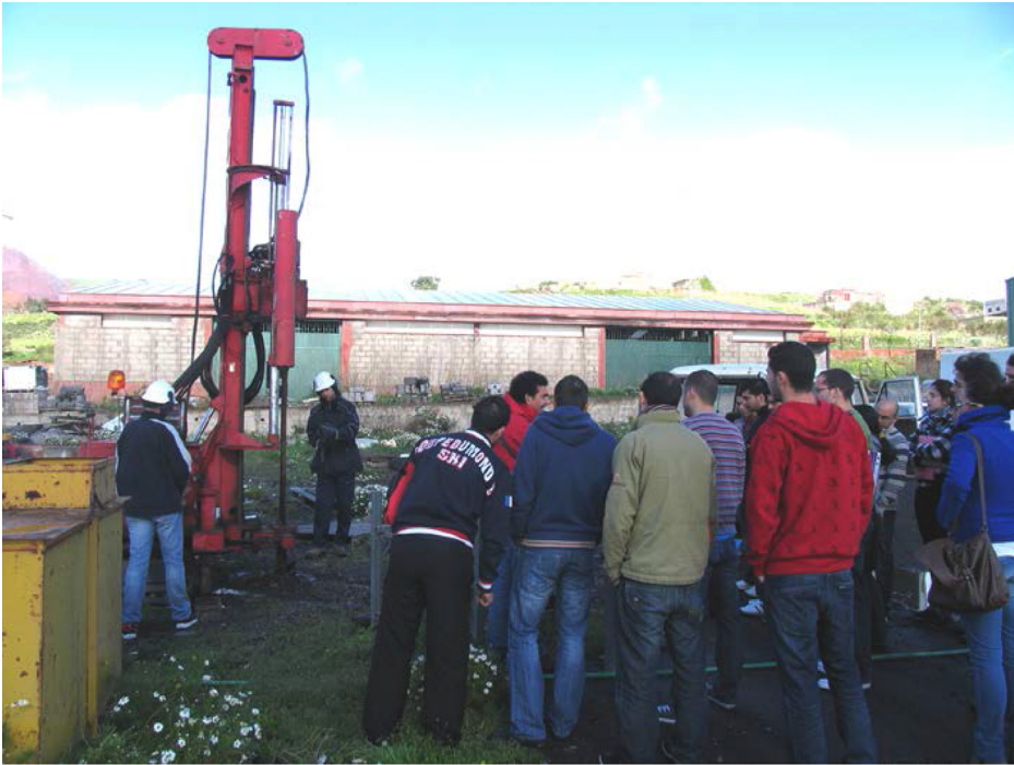
Figura 2. Ejecución de un sondeo en terreno volcánico durante la celebración del curso. (Santamarta, J.C., 2010)
