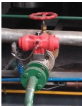
Ilustración 9. Válvula lodos. Fuente: Elaboración propia
