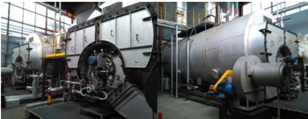
Ilustración 1. Frontal y lateral calderas. Fuente: Elaboración propia.
