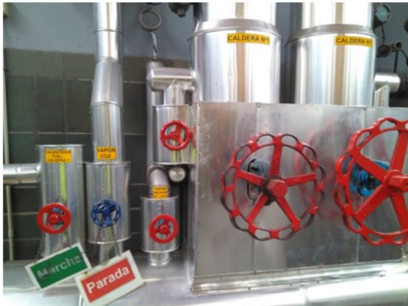
Salida del Vapor Caldera 1 y 2
