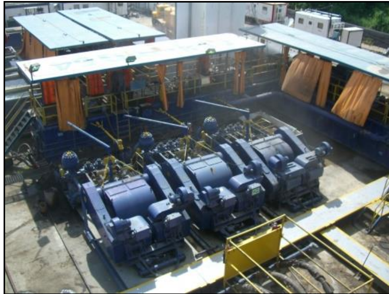
Bombas de lodo
