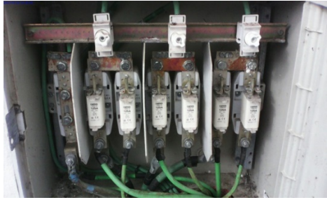
Fig. 1.5. Caja de Acometida para Naves 1 y 2.
