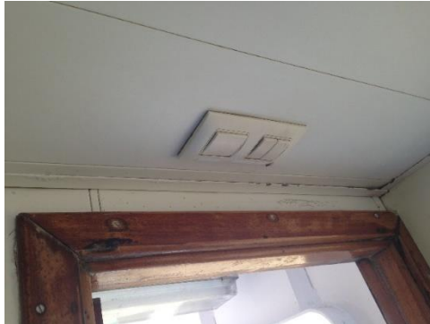
Ilustración 74. Interruptores a la entrada del puente desde la toldilla. Fuente: elaboración propia.
