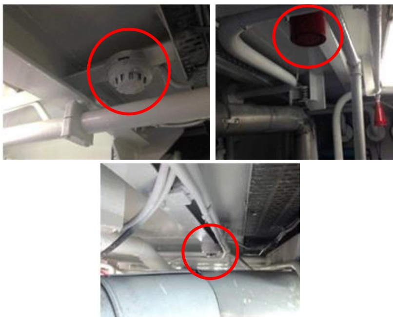
Ilustración 88. Detectores de humo y alarma contra incendios en la sala de máquinas. Fuente: elaboración propia.
