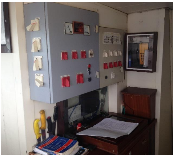
Ilustración 63. Control del sistema eléctrico, control de carga de baterías, entre otros. Fuente: elaboración propia.
