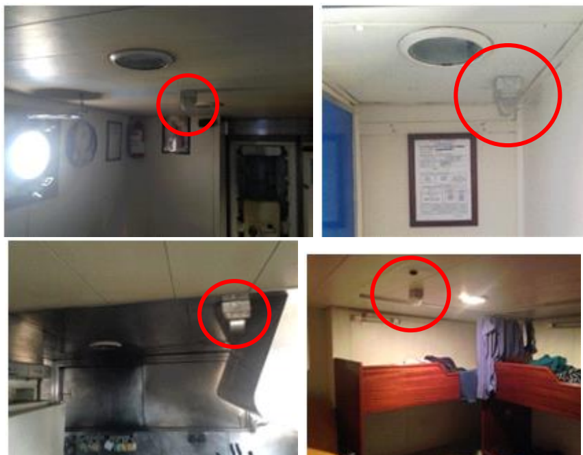
Ilustración 89. Luces de emergencia en la habitación. Fuente: elaboración propia.
