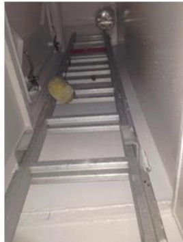
Ilustración 101. Salida de emergencia de los camarotes de los marineros. Fuente: elaboración propia.
