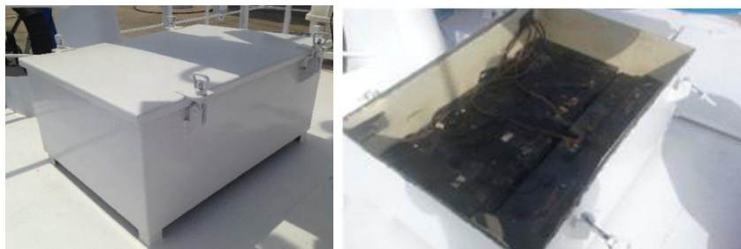
Ilustración 54. Ubicación del grupo de baterías de respeto y su aspecto externo.
