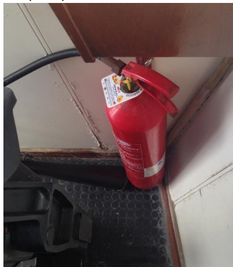
Ilustración 73. Extintor ubicado en el puente. Fuente: elaboración propia.
