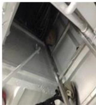
Ilustración 95. Escalera de emergencia para salir de la sala de máquinas. Fuente: elaboración propia.
