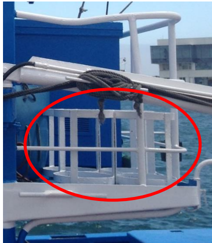
Ilustración 26. Estructura donde se ubican las bombonas de gas para la cocina. Fuente: elaboración propia.
