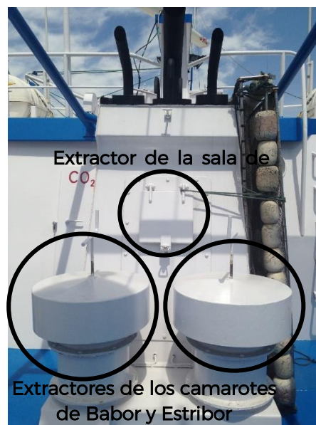
Ilustración 35. Chimenea del buque, indicando la ubicación de los extractores de la sala de máquinas y los extractores de los camarotes tanto de estribor como de babor. Fuente: elaboración propia.
