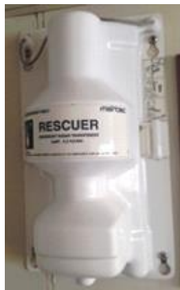
Ilustración 46. Transpondedor radar ubicado en el interior del puente. Fuente: elaboración propia.
