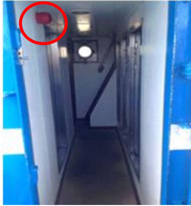
Ilustración 90. Alarma sonora contra incendios. Fuente: elaboración propia.
