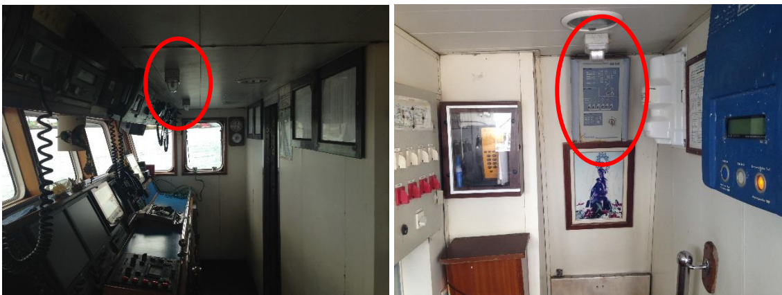
Ilustración 91. Luces de emergencia del puente y cuadro de alarmas de la sala de máquinas. Fuente: elaboración propia.
