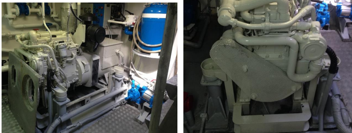
Ilustración 20. Motor auxiliar de la banda de estribor. Fuente: elaboración propia.
