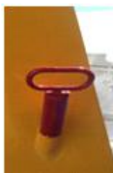
Ilustración 105. Llave de corte de combustible en caso de emergencia. Fuente: elaboración propia.
