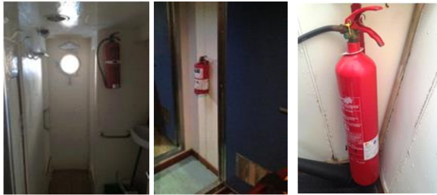
Ilustración 96. Extintores ubicados en la habitación y el puente. Fuente: elaboración propia.
