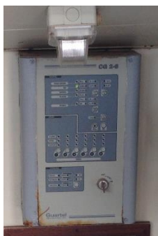
Ilustración 65. Cuadro de alarmas de la sala de máquinas. Fuente: elaboración propia.
