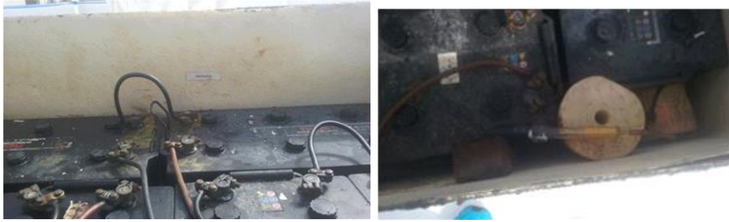
Ilustración 55. Vista de cerca del grupo de baterías de respaldo y el densímetro para saber su estado respectivamente. Fuente: elaboración propia.
