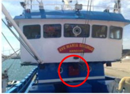
Ilustración 100. Manguera contra incendios ubicada bajo el puente de mando para abastecerá a la parte de proa del buque en caso de incendio. Fuente: elaboración propia.
